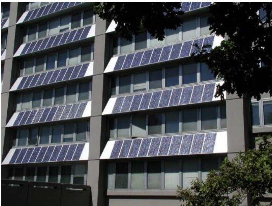
Kuva 6. Aurinkopaneelit integroituna rakennuksen aurinkosuojaukseen. (Inhabitat. 2015)
