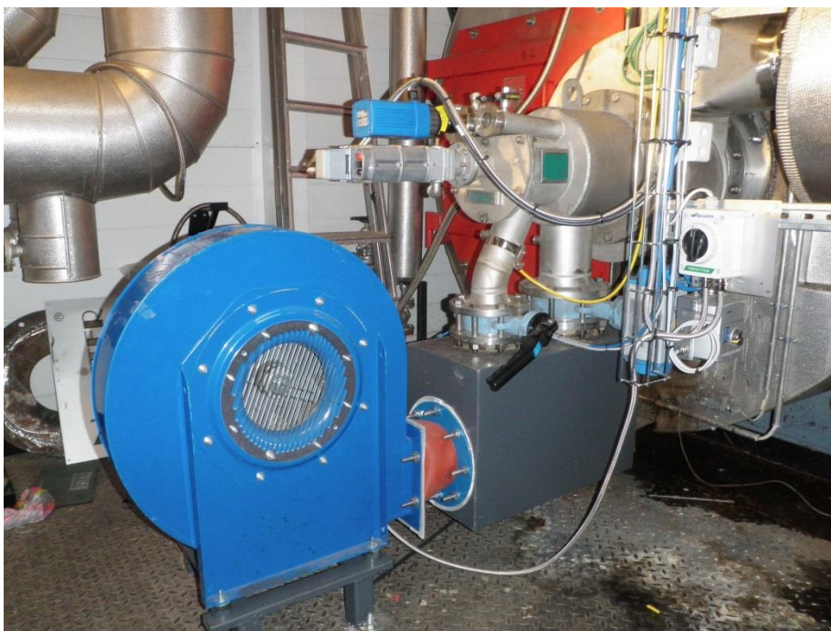
Kuva 10. Kaasupoltin kiinnitettynä kattilaan.
