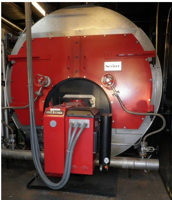
Kuva 4. Suurempi 3MW:in kattila Oilonin öljypolttimella.
