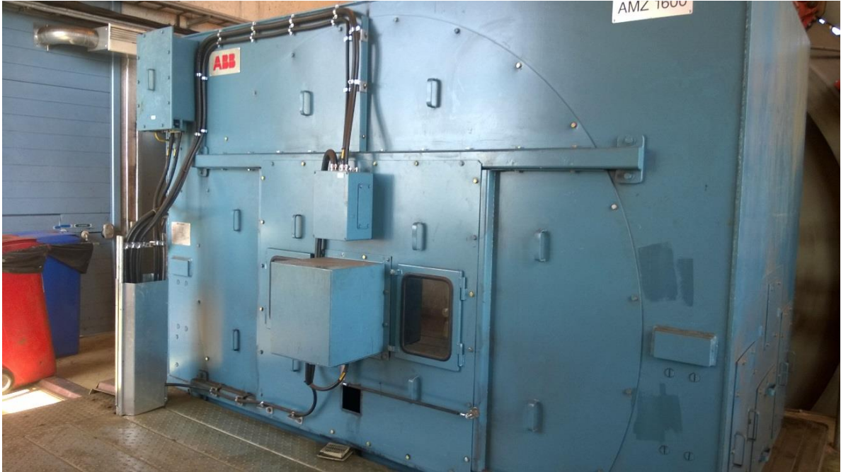
KUVA 4. Nostokoneen koteloitu sähkömoottori
