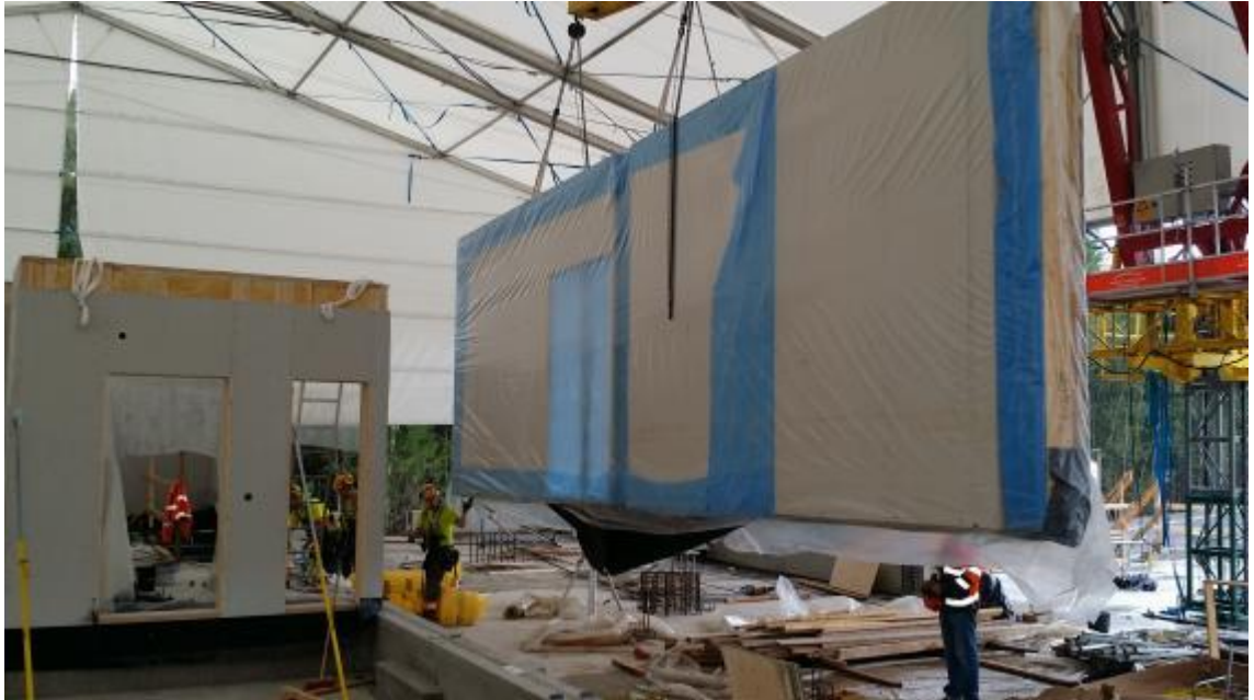
Kuva 11. A-lohkon toisen kerroksen puuelementtien asennusta, mitattavia asioita kuvassa on nostotyön kesto, sekä asennuksen kesto väliaikaistuille.
