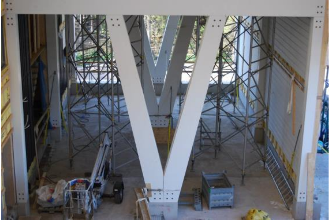
Kuva 5. Pölkky Oy:n valmistamat tuulitunnelin liimapuusta valmistetut pilaripalkistot.
