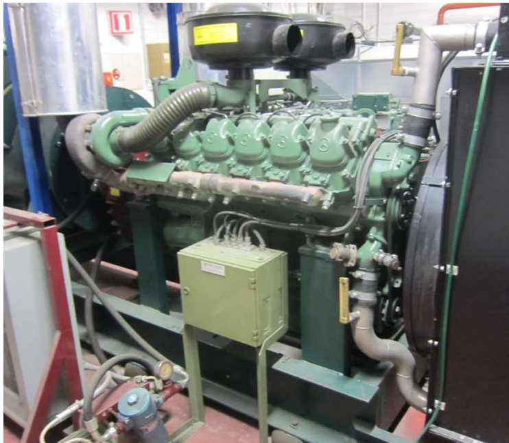
Kuva 6. 1EY01 varavoimakoneen dieselmoottori
