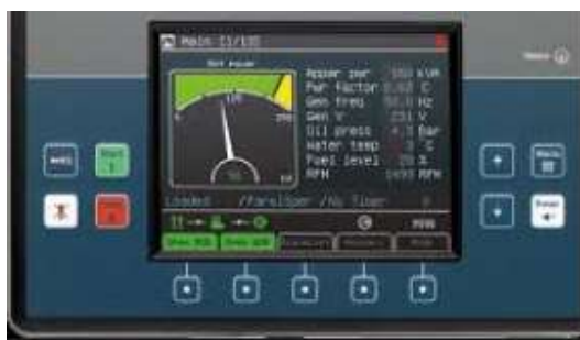
Kuva 14. Erään valmistajan automatiikan ohjauspaneeli
