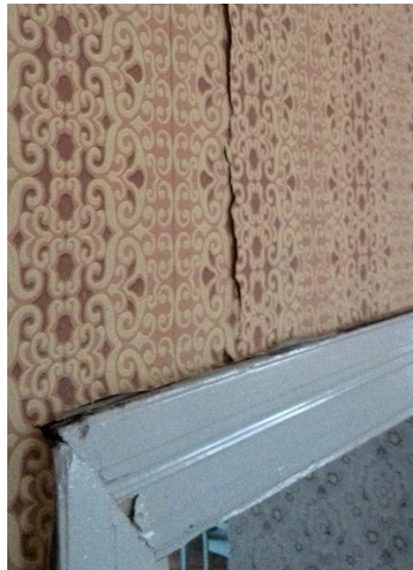
Kuva 28. Välioiven yläpuolinen repeämä tapetissa
