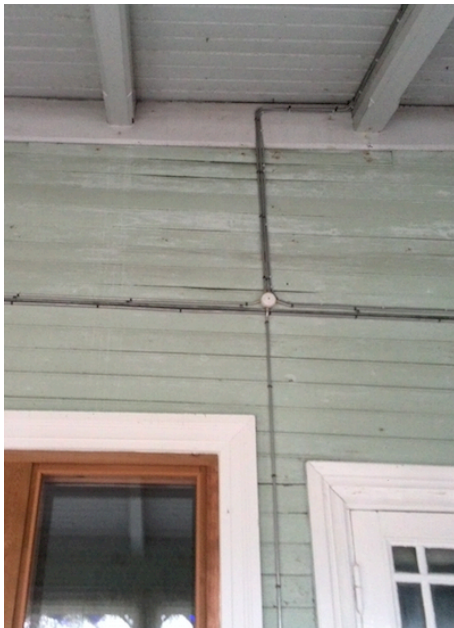
Kuva 27. Kuistin paneeliseinän vaurio
