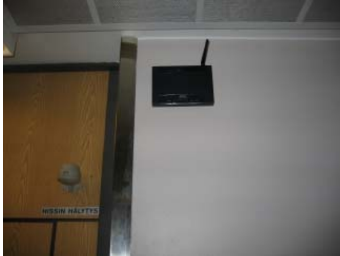
Kuva 13 Tukiaseman sijoitus C-talon porraskäytävässä
