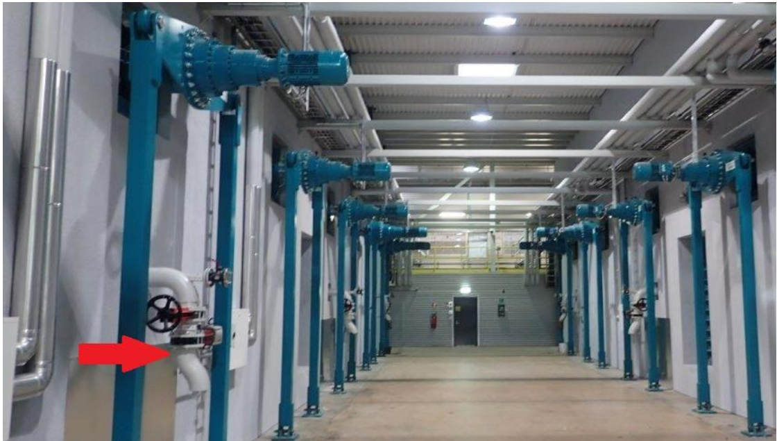
Kuvio 2. Mädättämöt 1 (vasen) ja 2 (oikea), mädättämöiden välinen käytävä ja sekoittimet. Kuvassa vasemmalla etuosassa näkyy myös näytteenotto piste 1/8. (Rousu 2015.)
