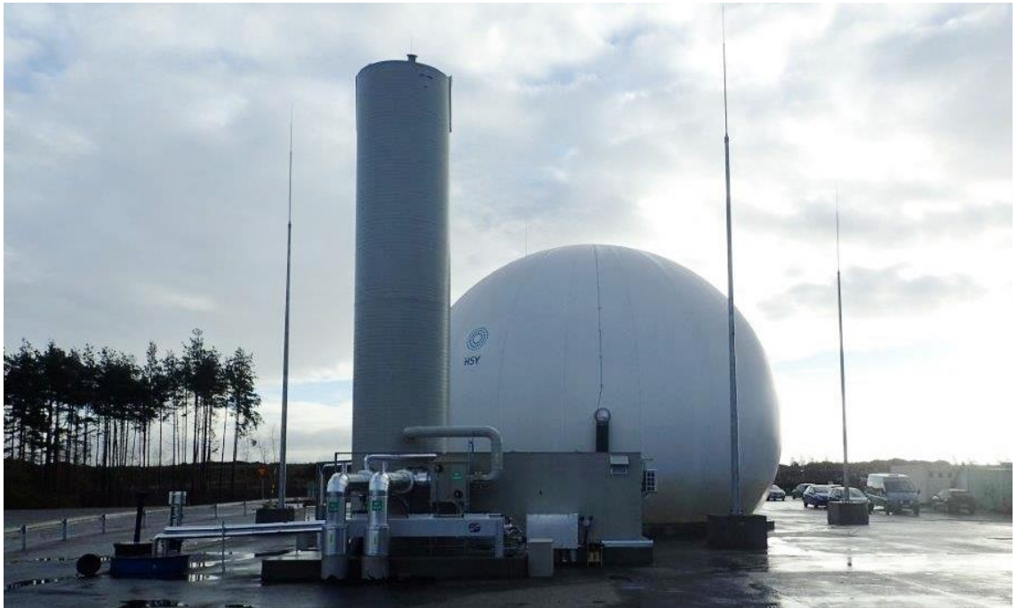
Kuvio 6. Biokaasulaitoksen rikinpoistosarake, takana biokaasun varastosäiliö. Rikinpoistosarakkeen edessä näkyy maan alta tulevat putket, joita pitkin biokaasu virtaa mädättämörakennuksesta. (Rousu 2015.)
