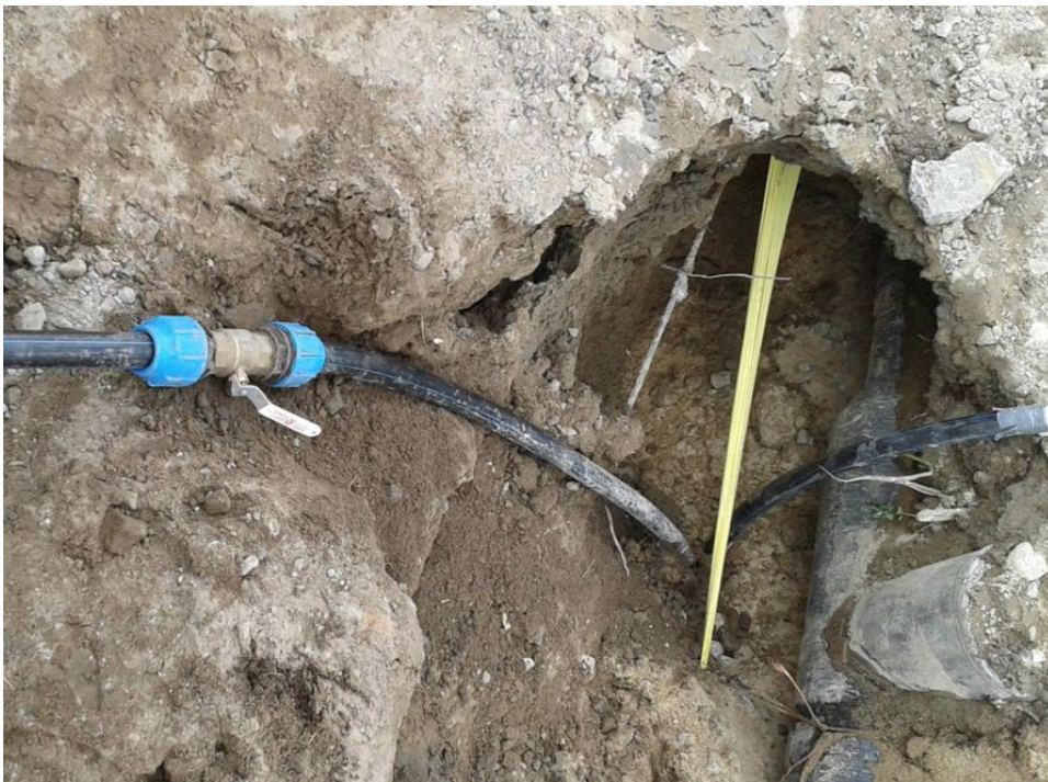
KUVA 20. Taloventtiilillä yhdistettävät vesijohdot
