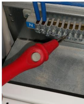
Kuva 11. Mittaus suoritetaan N-kiskon ja PE-kiskon väliltä
