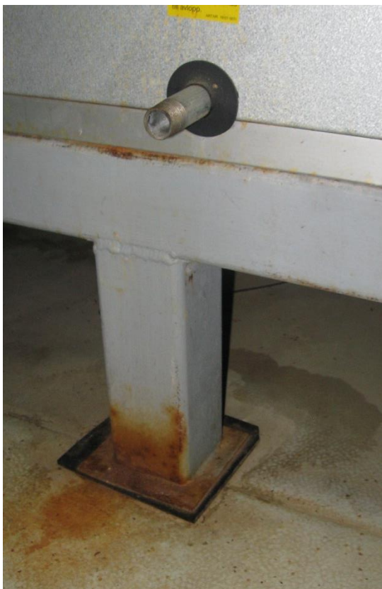
Kuva 5. Kondenssiveden aiheuttama ruostevaurio koneen jalassa (TK 1210).
