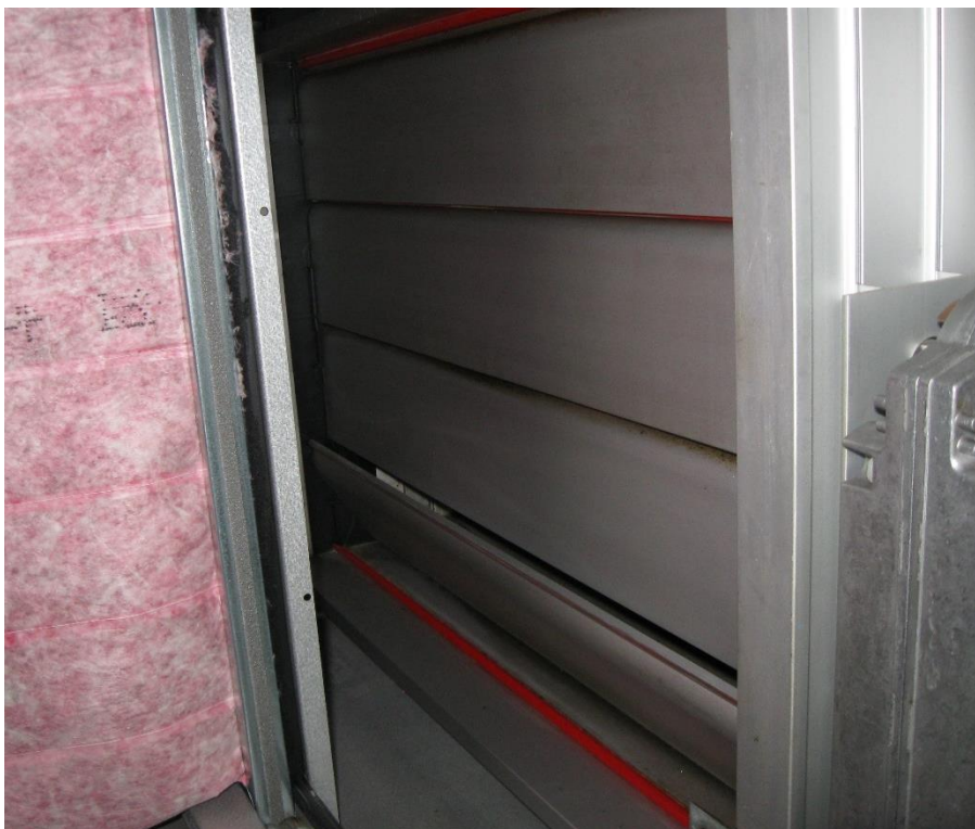
Kuva 2. Raitisilmapellin yksi pala on pois paikoiltaan (TK 1210).
