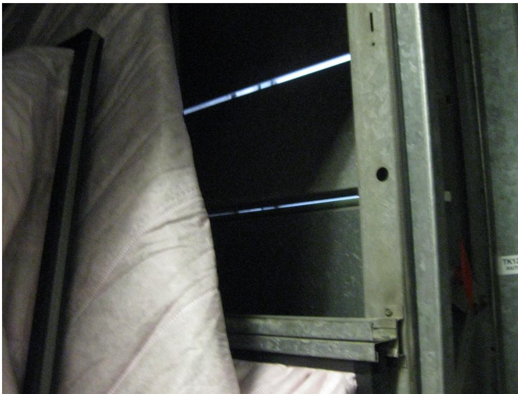
Kuva 1. Raitisilmapelti ei mene loppuun asti kiinni, vaikka kone on sammutettu (TK12).
