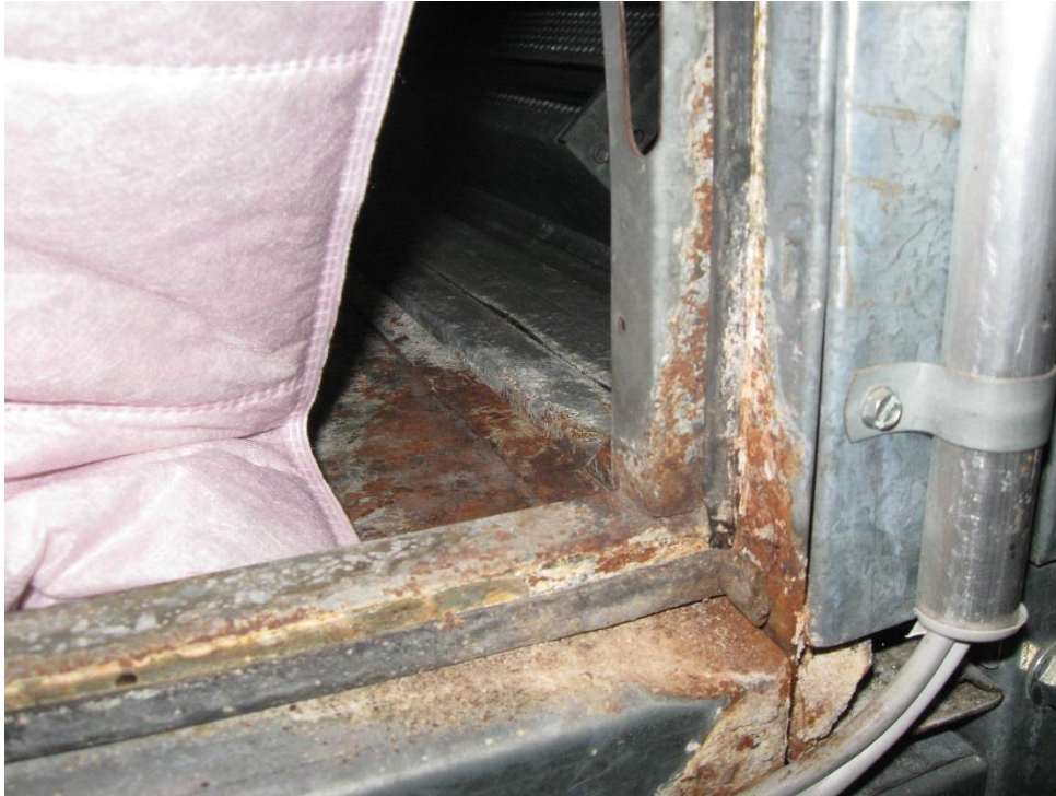
Kuva 3. Ruostevaurioita suodatinkammiossa (TK11).
