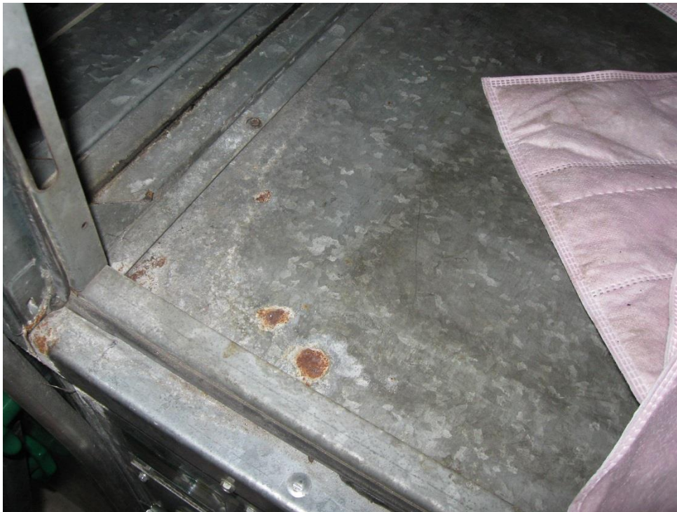
Kuva 4. Ruostevaurioita suodatinkammion pohjalla (TK 9).
