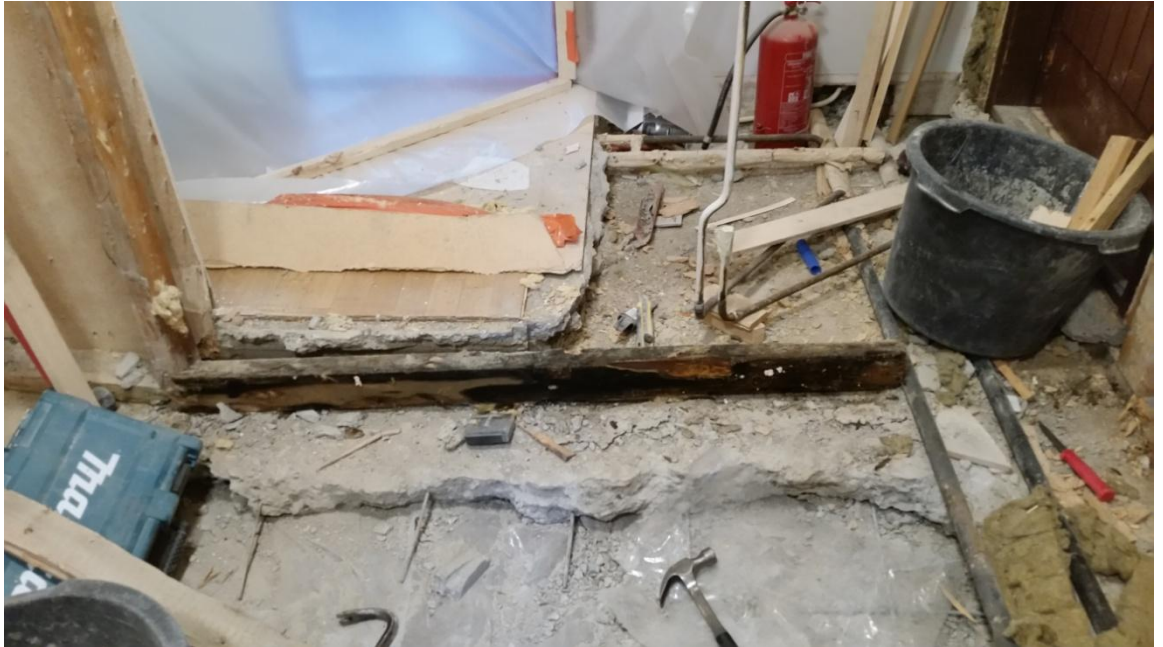
Kuva 1. Kylpyhuoneen ja käytävän välinen alajuoksu.
