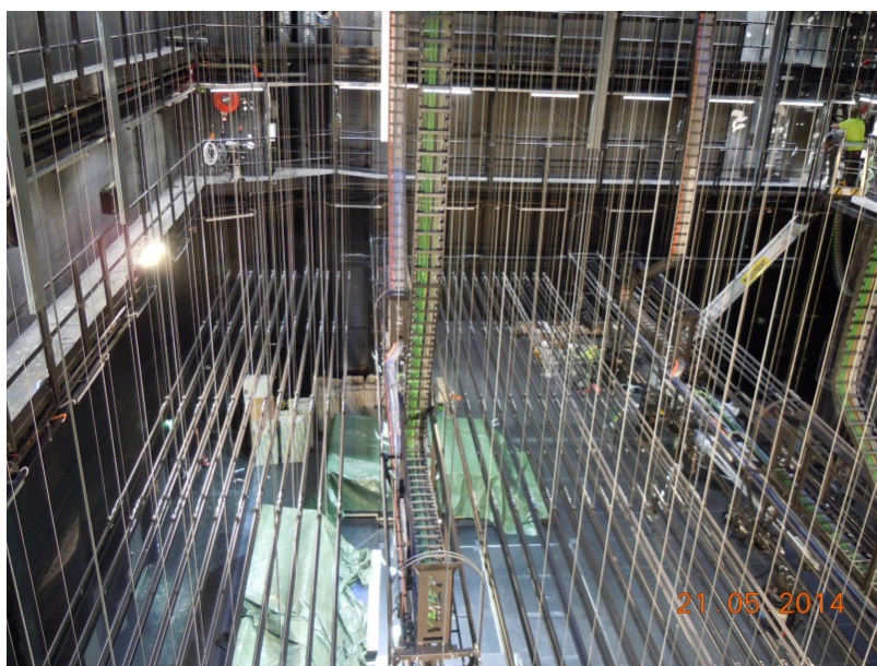
Kuva 9 , Kuopion kaupunginteatterin suuren puolen näyttämötornin lavastetangot ja valoansaat on laskettu alas. Niiden takana näkyvät myös tornin sillat.
