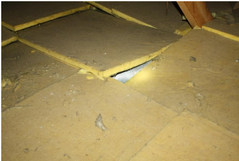
Kuva 8. Talo B Eristämätön IV-putki.
