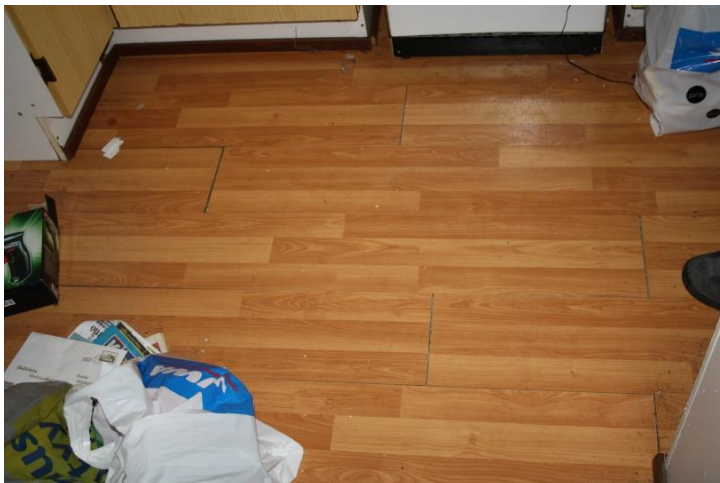
Kuva 16. Laminaatti turvonnut ja irti liitoksistaan.
