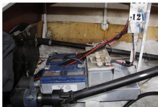
Kuva 13 Akkupeti ja päävirtakytkimet (Kuvannut P. Vallinmäki)
