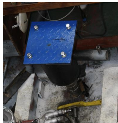
Kuva 17 Merivesikaivo (Kuvannut P. Vallinmäki)
