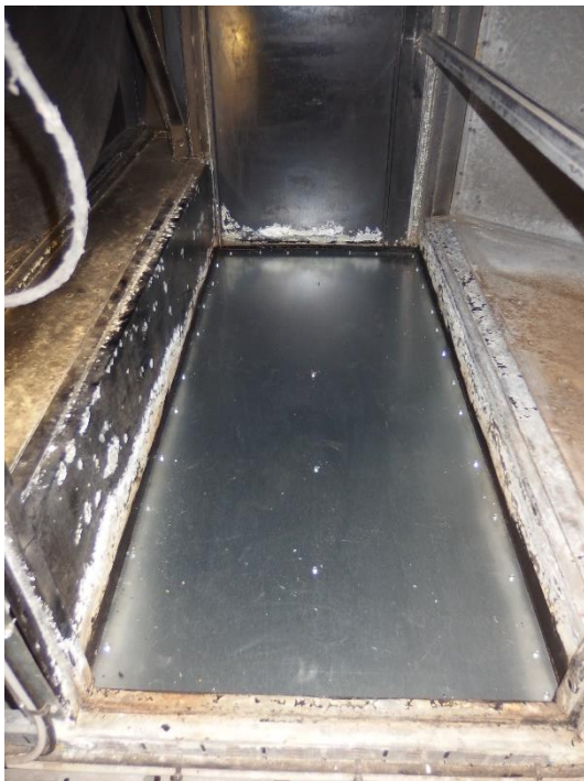
Kuva 17. Kuumasinkityllä pellillä pellitetty raitisilmasuodatinkammio, ennen pellin laittamista suodatinkammio puhdistettiin kunnolla ja pellin alle laitettiin elastiinista ainetta.
