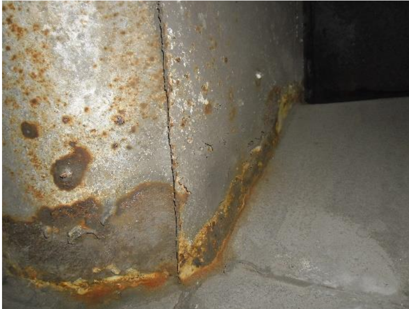
Kuva 19. Syöpynyt ja lähes puhki ruostunut raitisilmakanava
