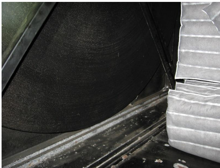
Kuva 3. Pyörivä lämmöntalteenottokenno tuloilmakammioista kuvattuna
