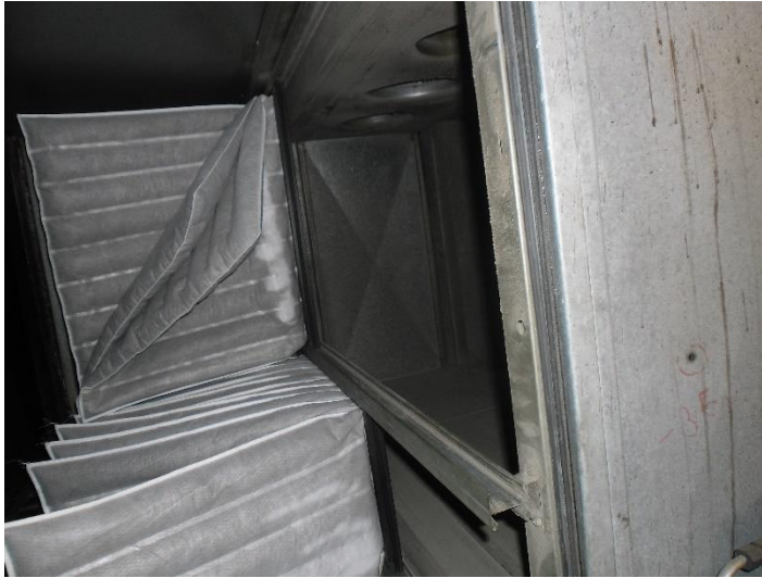
Kuva 12. Ilmastointisuodattimia suodatinkarmeissa, osa suodattimista kuvassa poistettu ilmastointikanavan tarkistuksen ajaksi.
