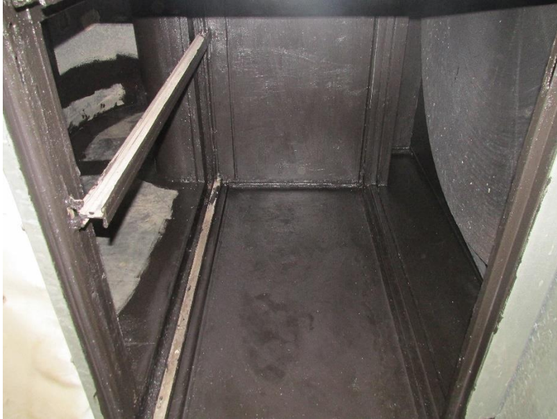
Kuva 15. Elastinisella aineella pinnoitettu raitisilmasuodatinkammio.
