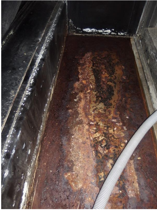
Kuva 16. Kuntokartoituksessa havaittu huonossa kunnossa ja puhki ruostunut raitisilmasuodatinkammio
