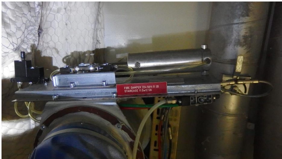
Kuva 7. Palopelti ilmastointikanavassa ulkoapäin kuvattuna
