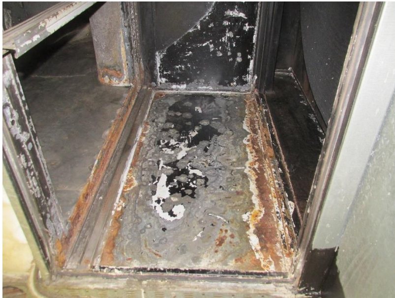
Kuva 14. Kuntokartoituksessa havaittu huonokuntoinen ja syöpynyt raitisilmasuodatinkammio ennen elastiinisella aineella pinnoitusta.
