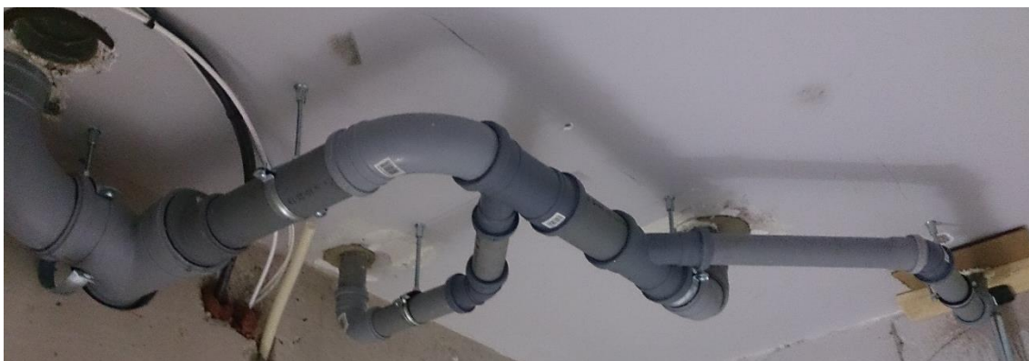
Kuva 8. Viemärihajotukset kylpyhuoneen alakatossa.
