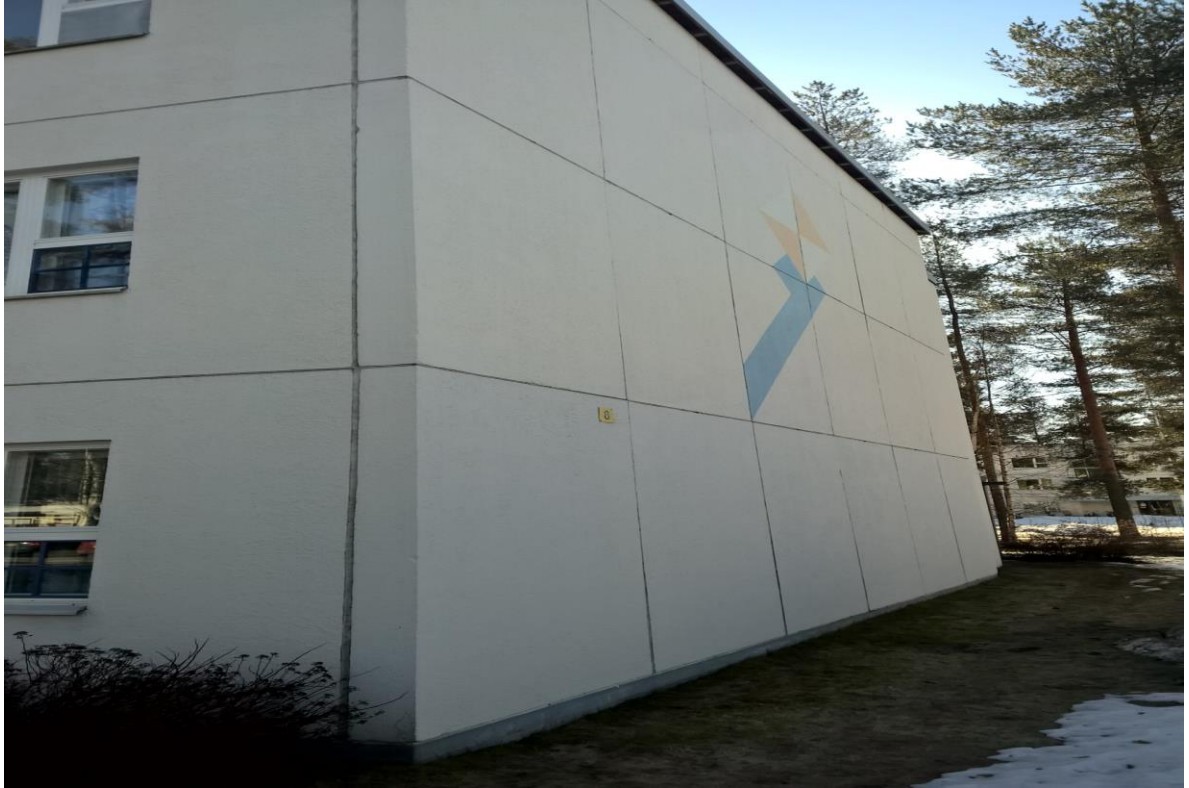
Kuva 2 Pesubetonipintaisen ulkokuoren visuaalisuutta on paranneltu päätyseinän kuvioinnilla. Julkisivun pinta on silmämääräisesti siistissä kunnossa.
