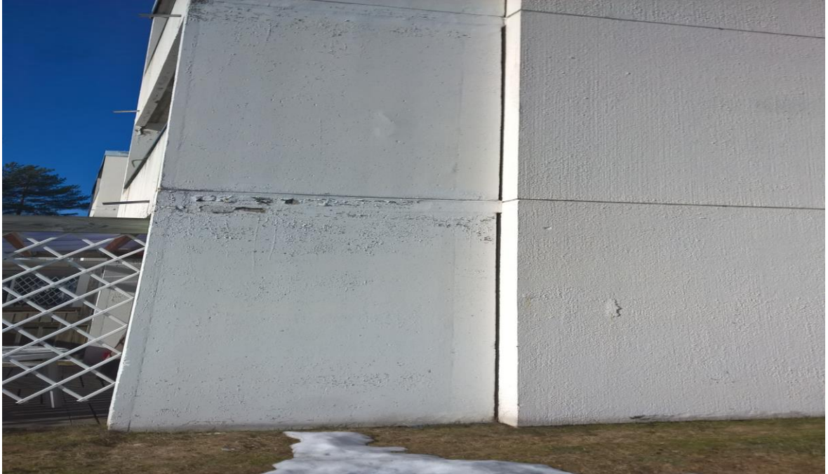
Kuva 4 Parvekelaatan ja -pielen liitoskohdissa teräkset olivat jo pääsääntöisesti tulleet näkyviin, myös maanperän nostama kosteus näkyi osissa seinä- ja piellelementtien alareunoissa.
