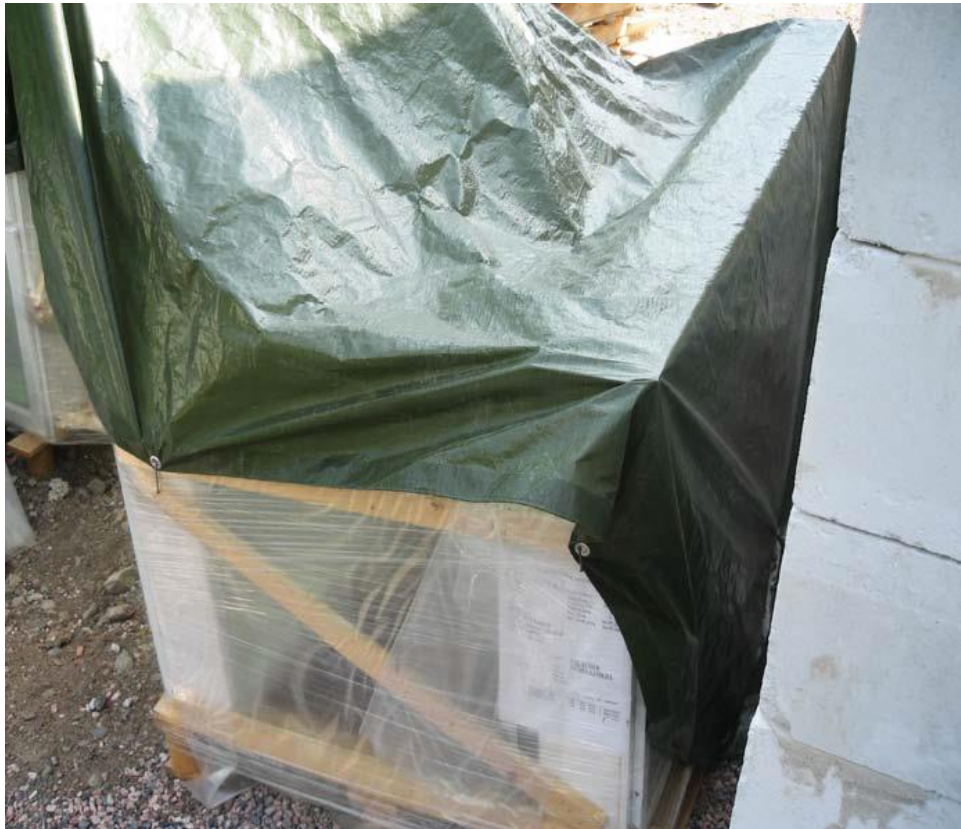
Kuva 14. Ikkunoita varastoituna työmaalle. Kuljetuksen aikaisen suojauksen lisäksi on käytetty suojapeitettä. (Ratu RT S-1232 2013, 9).
