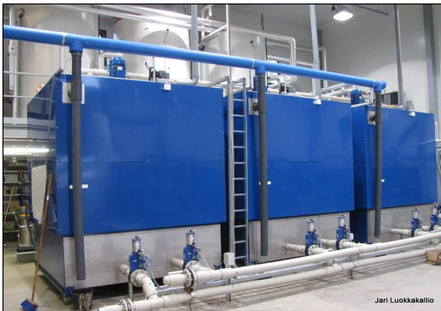
Figur 8. Hygienisering av rötresten sker i tre stycken hetvattenackumulatörer ( 3 \times 10^3 m 3 ).
