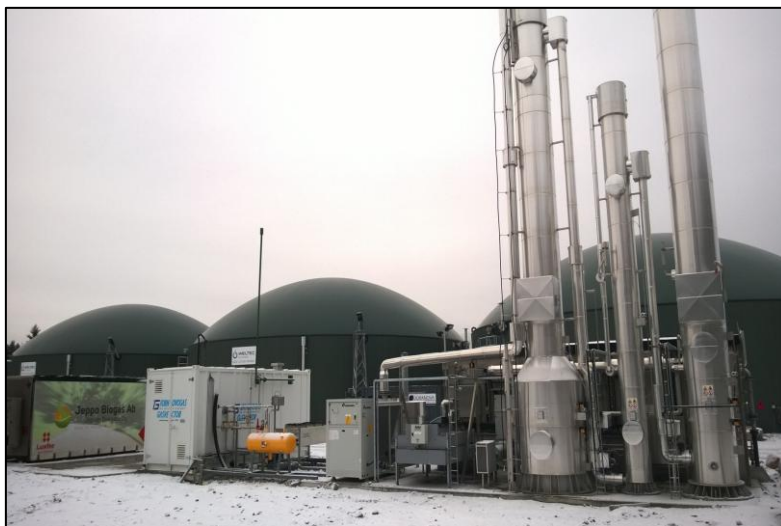
Figur 4. Anläggningens uppgraderings- och kompressorenhet.
