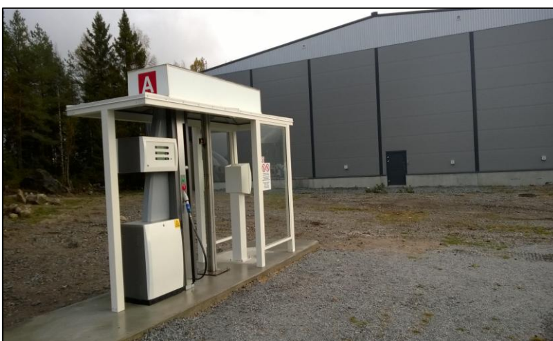
Figur 7. Anläggningens gastankningsstation för fordonsbränsle (CBG).
