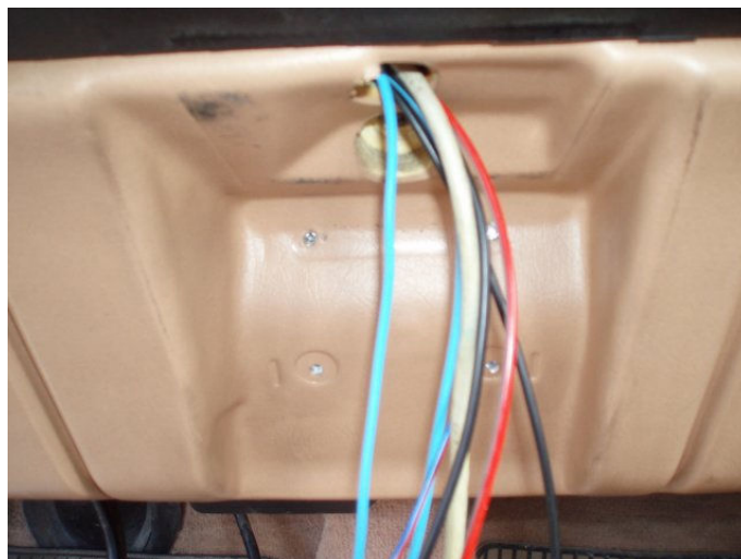
Kuva 18 Tiedonkeruulaitteelle liitettävät johdot
