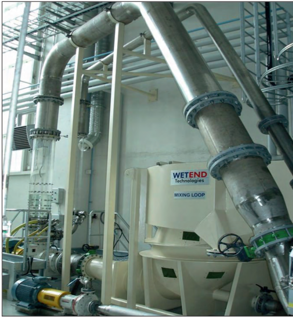
KUVA 2. Sekoitusluoppi. Putkiston läpinäkyvä osa alhaalla vasemmalla (kuva Mamk Oy)
