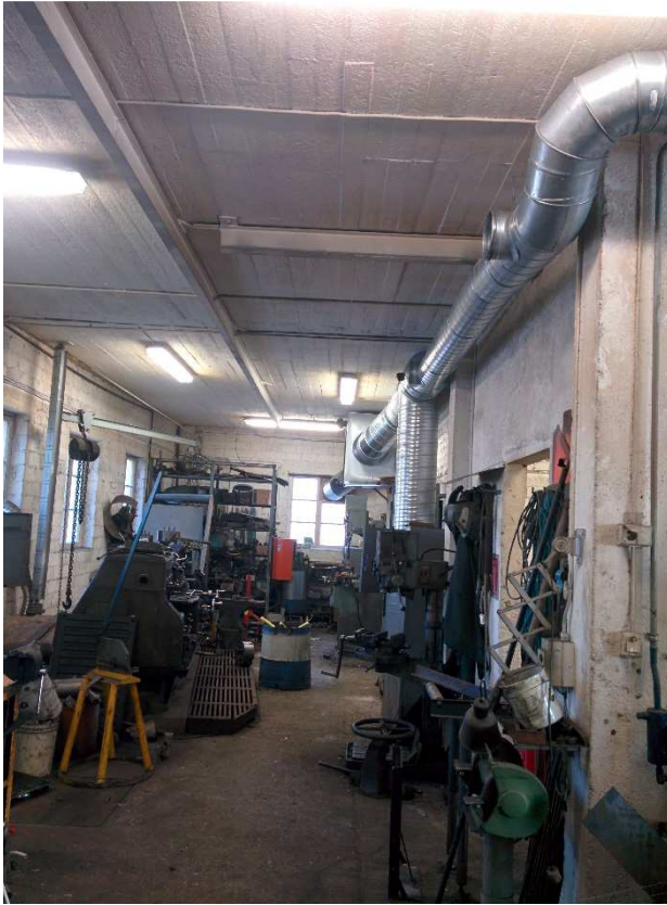
Figur 12 Dragning av kanaler från kompressorn. Luften kommer upp genom det stigande röret i bild. Värmeväxlaren ses som en större låda i kanalen i bakgrunden. Fotograf Max Nybondas. Västanfjärd 2015.
