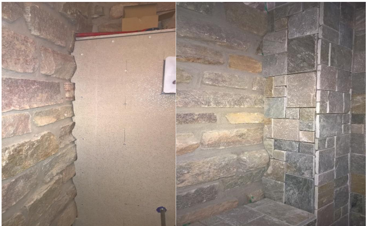
Kuvat 4 ja 5 Levytyksen ja laatoituksen hankaloituminen (Pasi Nikulainen 2015)
