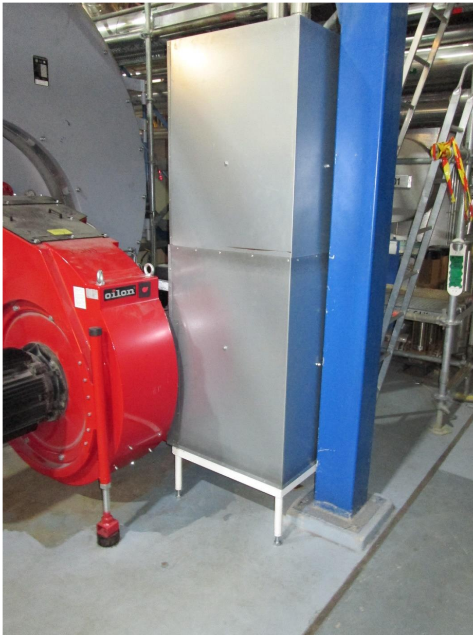
Kuva 13. Savion voimalaitoksen K2-kattilan polttimelle tehty imuilmakanava
