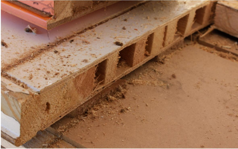
Kuva 4. 1941 vuoden ovi jonka ulko- ja sisäpinta on ohut vaneri, välissä on pystysuunnassa olevat puurimat, rimojen välejä ei ole täytetty millään.
