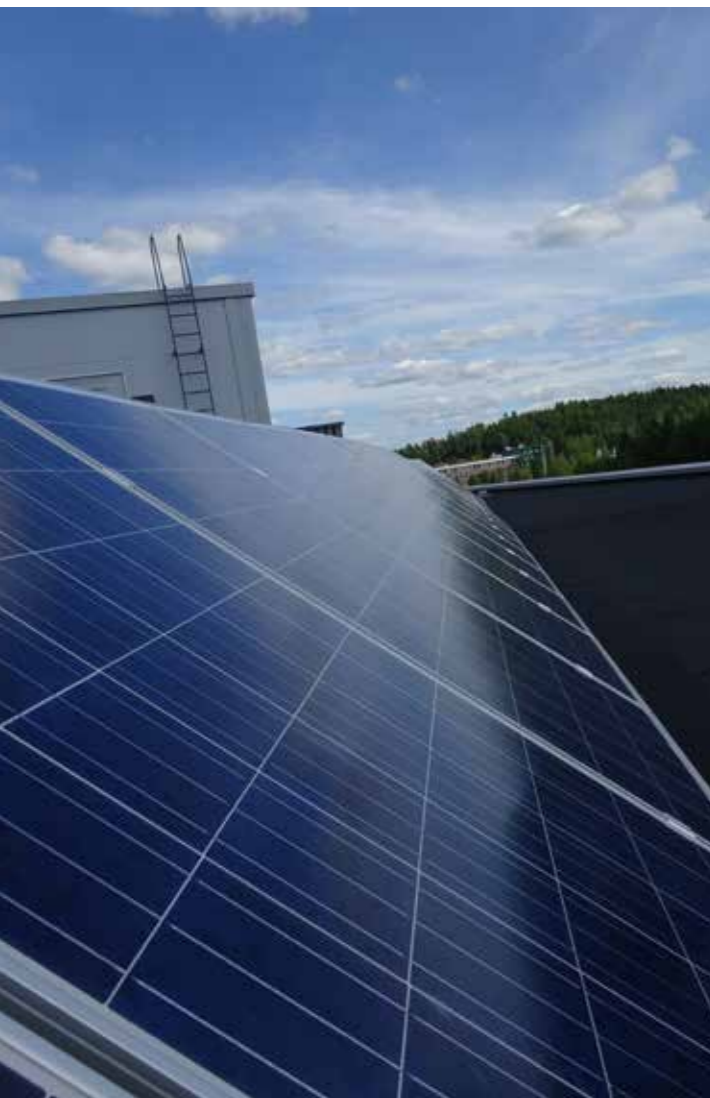
Figure 3. Solar panels (photo Jussi Kuusela)
