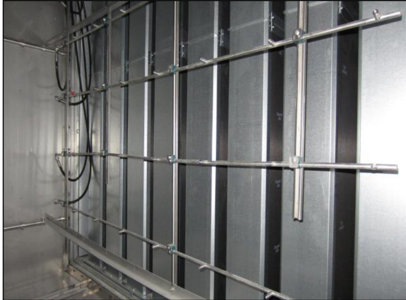
Kuvio 3. Kanavistoon asennettu putkisto
