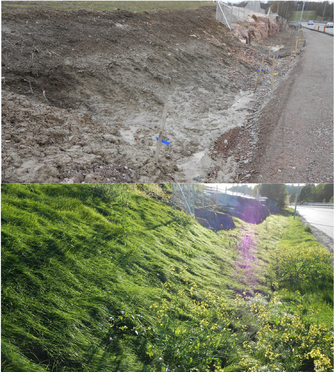
Kuva 1. Savirinteen maisemointi Vantaan Ylästöntiellä. Yläkuva otettu keväällä 2015, alakuva syksyllä 2015. Vantaan Ylästöntien peruskorjauksen yhteydessä sortuva jyrkkä savirinne maisemoitiin nurmettamalla. Toimenpide sisälsi multa- ja nurmikerroksen lisäämisen saven päälle. Savimaalla on hienojakoisuutensa vuoksi erityinen taipumus muuttua kastuessaan plastiseksi myös ilman siihen kohdistuvia ulkopuolisia leikkausvoimia. Tämä tekee kasvillisuuden luonnollisesta muodostumisesta erityisen vaikeaa.
