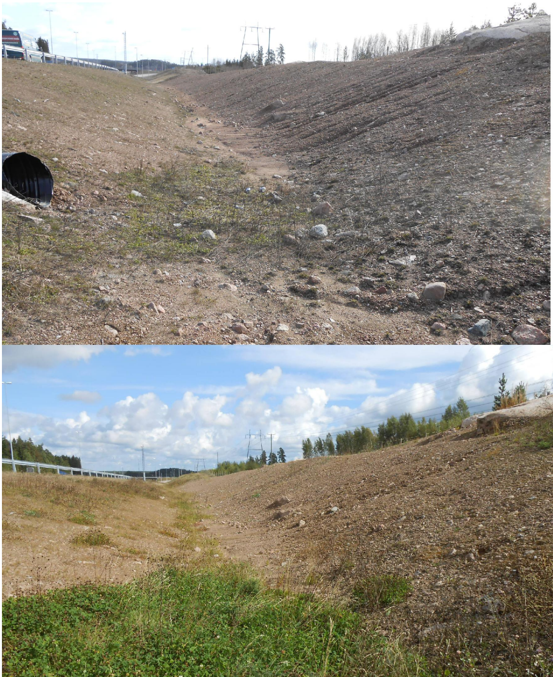
Kuva 2. Huolella suunniteltu soraluiska E18-väylän varressa Loviisassa. Yläkuva otettu keväällä 2015, alakuva syksyllä 2015. E18-väylän varrella Loviisassa on jätetty paljas soraluiska paahdeniittyjen kasvillisuudelle. Sorarakenteiden tyypillisiä eroosiovaurioita ovat yläkuvassa selkeästi näkyvät, veden kaivertamat uomat ja maa-aineksen sortumat ojiin. Luiskan loivuuden ansiosta merkittäviä vaurioita ei kuitenkaan ole syntynyt. Huolimatta alueen karusta ulkonäöstä keväällä, pienikokoinen luonnonkasvillisuus voi siellä hyvin.
