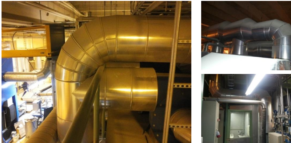
KUVIO 29. Puhaltimen by pass säätö sekä kanavavedot.
