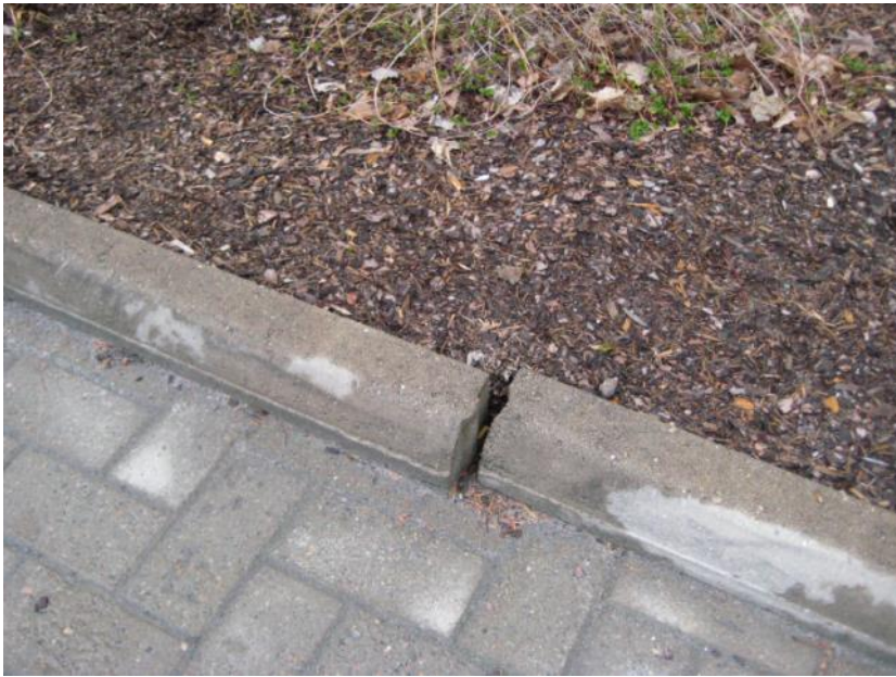
Kuva 26. Vaaraa aiheuttavat reunatuet korjataan välittömästi tai minimoidaan tapaturmariskit. Vauriokohta merkitään esimerkiksi varoitusvälinein.
