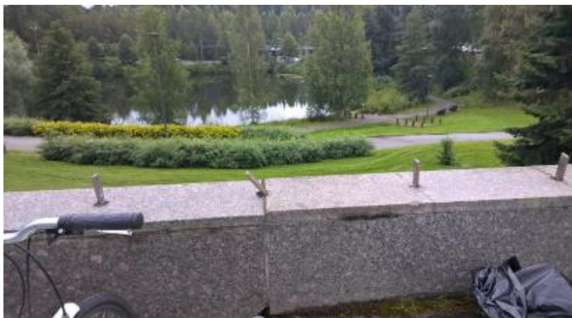
Kuva 56. Paikoitellen KYS Puijon sairaalan pääväylän ja rantapuiston välillä oleva suoja-aita puuttuu kokonaan ja siinä on teräviä ulokkeita, särmiä ja irtonaisia osia.
