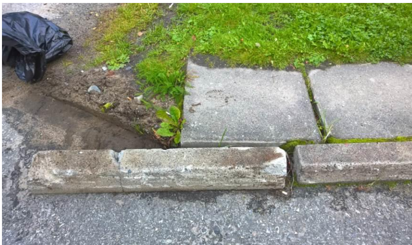
Kuva 29. Rikkoutuneet ja vaaraa aiheuttavat reunatuet korjataan välittömästi tai tapaturmariskit minimoidaan. Vauriokohta merkitään esimerkiksi varoitusvälinein. Varoitusvälineet eivät saa aiheuttaa kompastumisvaaraa.
