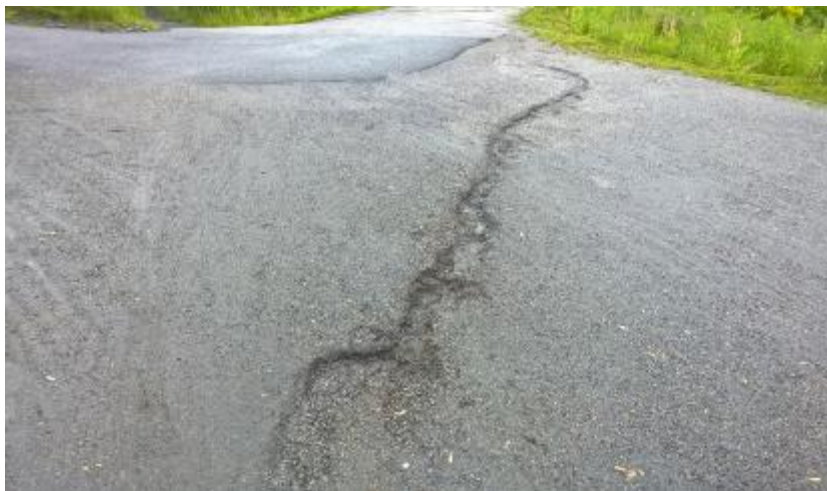
Kuva 10. Syöpymisen aiheuttamia ongelmia KYS Puijon sairaalan rantapuiston kivituhkapinnoitteisella pääkulkuväylällä.
