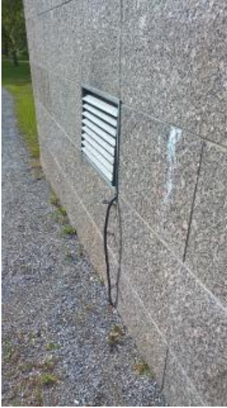
Kuva 20. KYS Puijon sairaalan rantapuiston pohjoiselta sisäänkäynniltä rantapuistoon johtavan luiskan oikealla puolella olevan muurin rikkonaiset rakenteet korjataan välittömästi.
