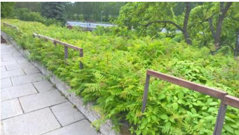
Kuva 54. KYS Puijon sairaalan ulkoympäristössä putoamisen estävät suojakaiteet ovat huonokuntoisia ja vaarallisia ja puuttuvat paikoitellen kokonaan.
