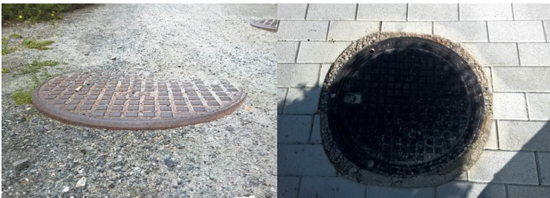
Kuva 32. Koholla olevat kaivonkannet aiheuttavat kompastumisvaaran. Koholla olevat kaivonkannet korjataan välittömästi tai merkitään varoitusvälinein. Esteettömällä kulkuväylillä ei saa olla yli 50 mm:n epätasaisuuksia.
