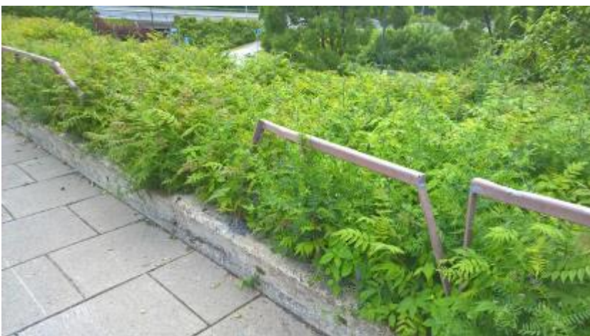
Kuva 55. Nykyinen suoja-aita KYS Puijon sairaalan edustalla on monin paikoin rikki. Suoja-aidassa on teräviä ulokkeita ja irtonaisia osia.
