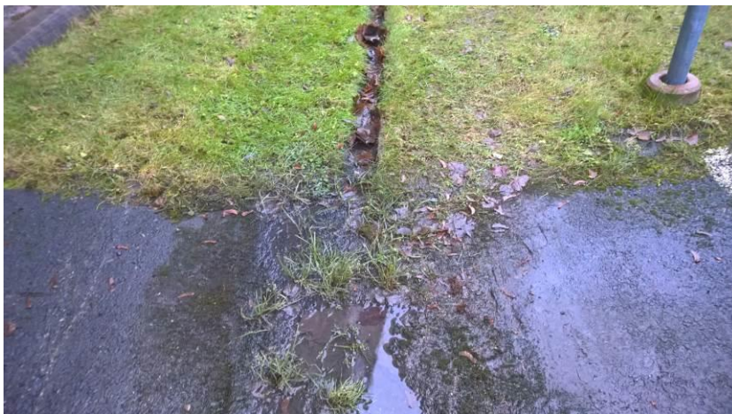
Kuva 30. Roskat, lehdet ym. orgaaninen aines poistetaan hulevesikouruista säännöllisesti veden esteettömän virtaamisen takaamiseksi
