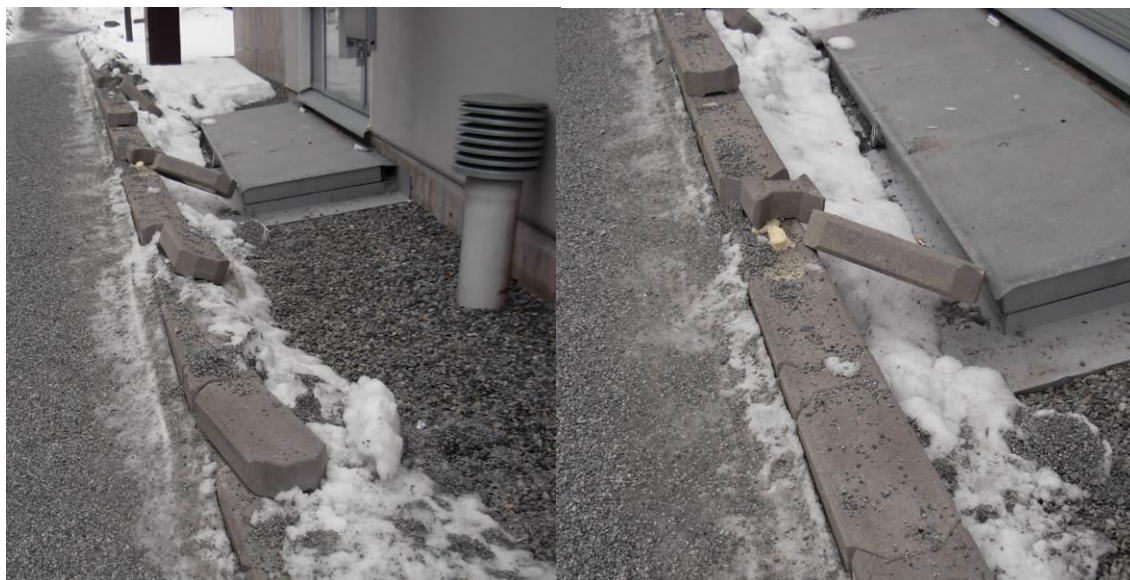
Kuva 33. Rikkoutunut muuri tai muurissa olevat vauriot korjataan välittömästi tai minimoidaan riskit. Vauriokohta merkitään varoitusvälinein.
