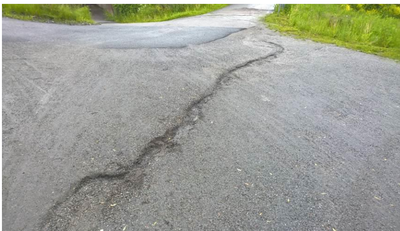
Kuva 10. Veden aiheuttamat syöpymät sitomattomilla päällysteillä korjataan välittömästi. Esteettömillä kulkuväylillä saa olla korkeintaan 50 mm:n epätasaisuuksia. Pienetkin epätasaisuudet aiheuttavat kompastumisvaaran liikkumis- ja toimintaesteisille ulkoympäristön käyttäjille.
