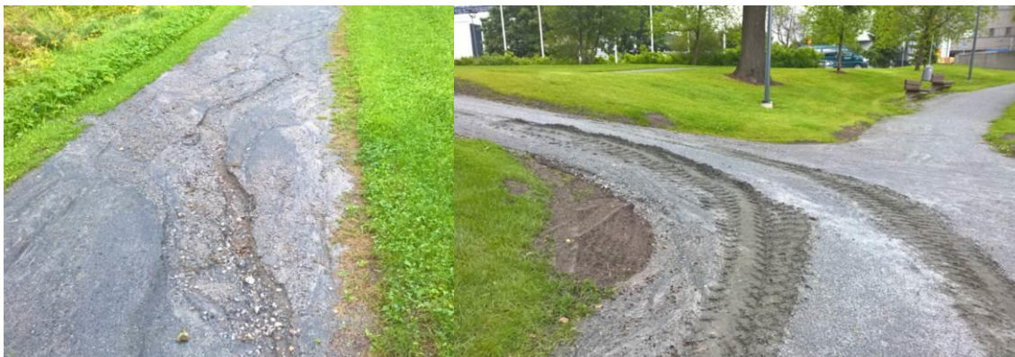
Kuva 27. Esteettömyyttä haittaavat vauriot korjataan sitomattomilta päällysteiltä välittömästi. Esteettömän kulkuväylän tulee olla kova, tasainen ja luistamaton.
