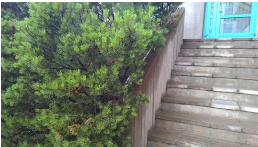
Kuva 16. Myös havupensaiden leikkauksissa noudatetaan esteettömyyden periaatteita. Kuvassa käsijohteeseen kiinni kasvava vuorimänty estää portaiden esteettömän ja turvallisen käytön. Käsijohteiden on säilyttävä esteettömänä koko portaiden matkalta.
