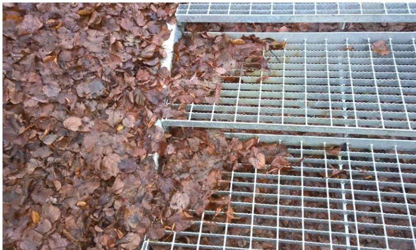
Kuva 34. Porrasaskelmilta poistetaan säännöllisesti mm. roskat, lehdet ja muu orgaaninen aines. Kasautunut lehtikerros voi aiheuttaa liukastumisvaaran sekä hankaloittaa liikkumis- ja toimintarajoitteisten käyttäjien kulkemista.
