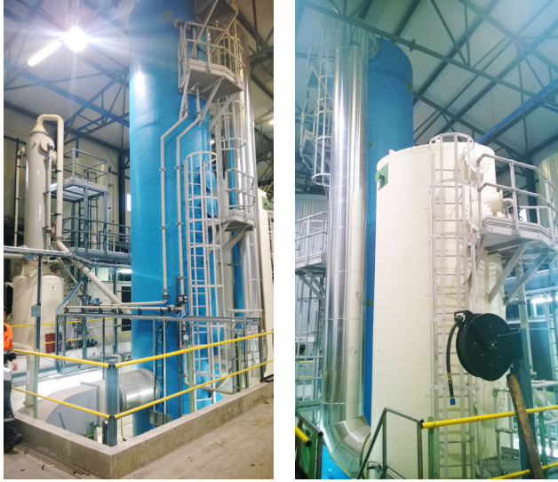
Kuva 6.4 Strippausprosessi Envor Biotechin biokaasulaitoksella Forssassa. Vasemmalla takana hiilidioksidin poistoyksikkö, etualalla ammoniakkistripperi, oikealla ammoniakkipesuri. Kuvat: Envor Biotech Oy
