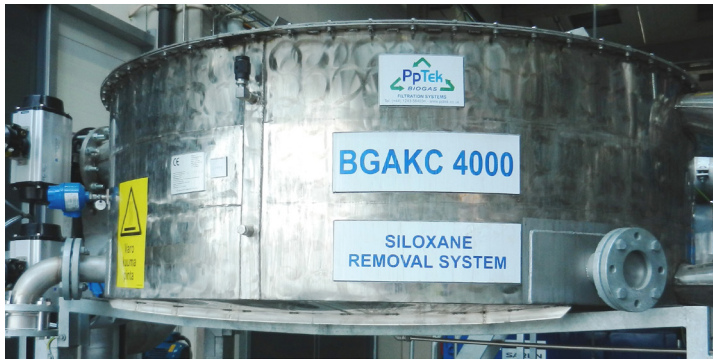
Kuva 7.1 Kemialliseen adsorptioon perustuva siloksaanien puhdistusyksikkö Ämmässuon kaatopaikalla Espoossa. Kuva: Ari Lamminen
