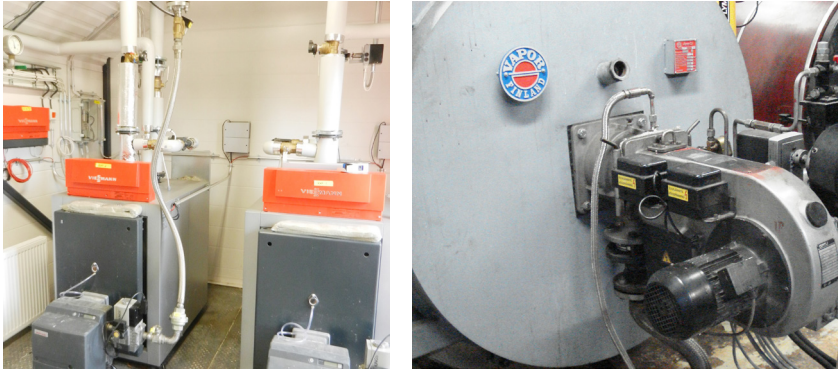
Kuva 7.8 Biokaasukäyttöisiä kattiloita: a) Kaksi 90 kW, lämpökattilaa ammattiopisto Lappian Tervolan yksikön keskuslämmitysjärjestelmässä. b) 1,4 MW:n kattila teollisen prosessi-lämmön tuotantoon. Kuvat: Ari Lampinen
