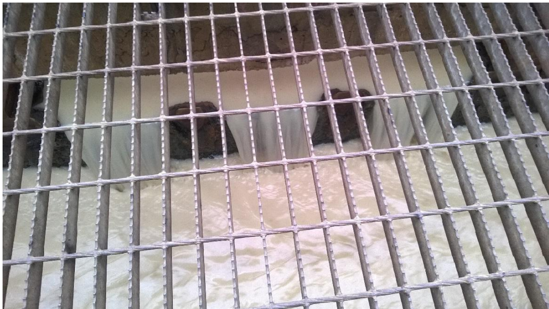
Kuva 4. Nesteen jätevesilaitoksen flotaattori 18.6.2014. Jätevesilaitokselle päässyt rasva haittasi flotaattorin toimintaa niin, että ylitteenä virtaava puhdistettu vesi oli maitomaisen sameaa.
