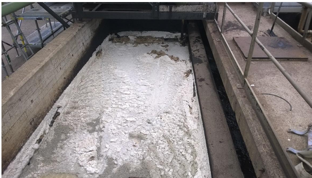
Kuva 2. Nesteen jätevesilaitoksen flotaattorin etuallas 18.6.2014. Rasva on tukkinut koko altaan perällä näkyvälle pintaskimmille saakka.
