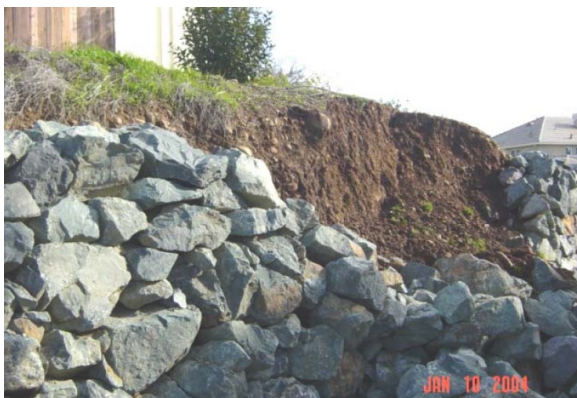
Kuva 42. Huonon rakentamisen takia sortunut tukimuuri [4]
