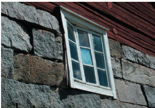
Kuva 14. Harkkokivinavetan liikkunut seinä [21]
