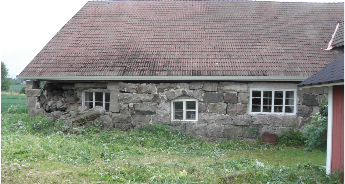
Kuva 19. Salaojituksen jälkeen sortunut navetan seinä. [3]
