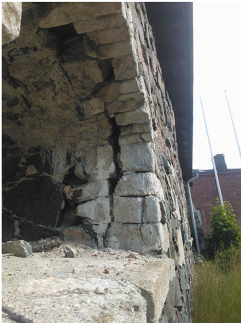
Kuva 18. Repeämä muurin holvissa. Bastioni Seth Suomenlinnassa. [kuva Insinööritoimisto Pentinmikko]
