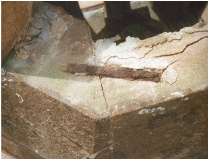
Kuva 20. Siteeksi käytetty terästappi laajenee ruostuessaan ja vaurioittaa kiveä. [29 s.172]
