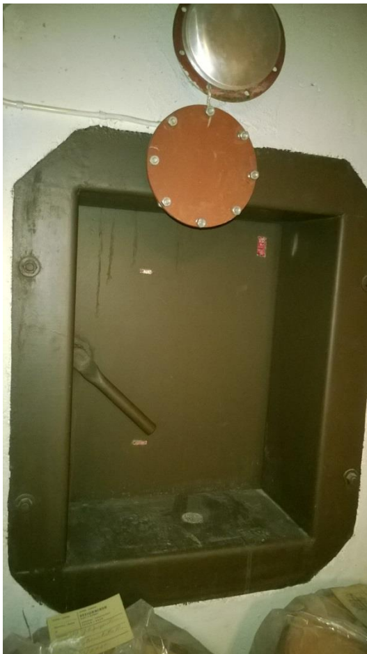
Kuva 13. Hätäpoistumiskäytävän suojaluukku SL-1.
