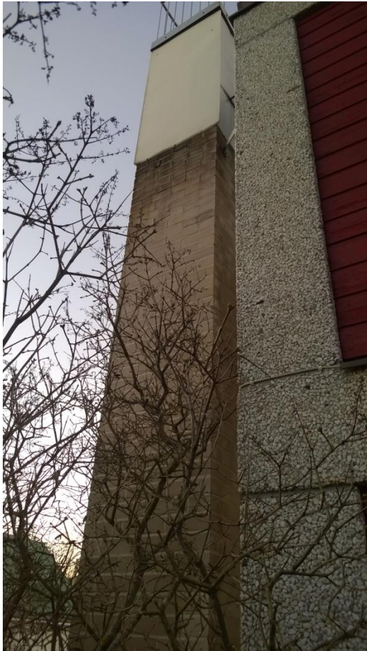
Kuva 36. Käytöstä poistettu savuhormi.
