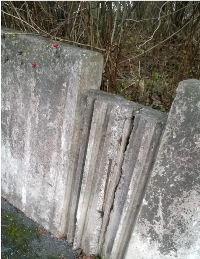
Kuva 9. Tukimuurien saumakohdassa ruostunut raudoite.
