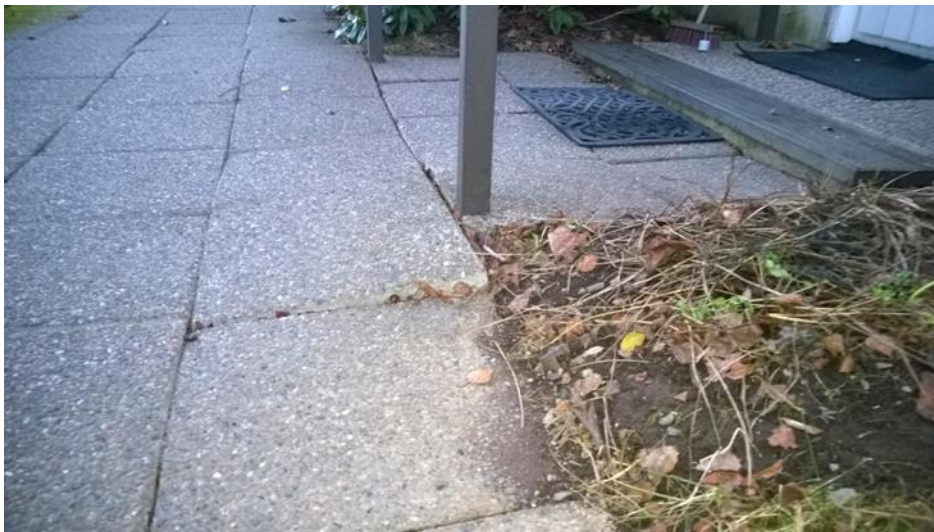
Kuva 1. Sisäänkäyntikatoksen pihalaatoituksessa ilmeisesti roudan aiheuttamaa elämistä.
