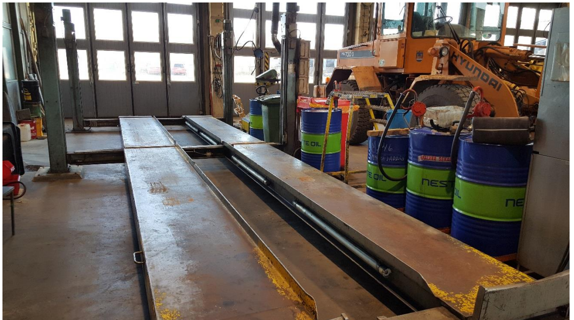
Kuva 13. Käytössä oleva siltanosturi.
