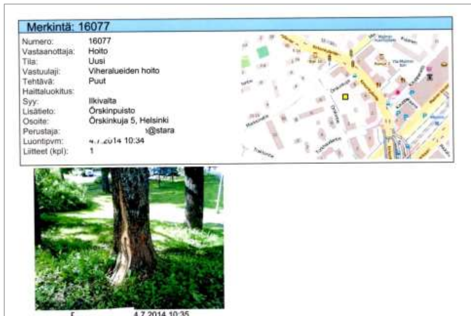
Kuva 4. Merkinnällä on ilmoitettu työnjohdolle ilkivallasta. Kuvakaappaus Mobilenote tiedostot.
