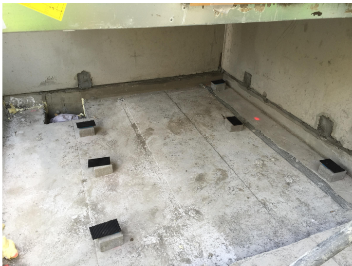
Kuva 4. Asennuslaput kylpyhuone-elementin alla. (6)
