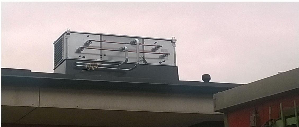
Kuva 11. Jussikylän päiväkodin keittiön poistoilmakoneena toimii vesikatolle asennettu suodattimilla ja vesiglykoli LTO-patterilla varustettu huippuimuri. Kuvanottohetkellä asennus on kesken, eristeet puuttuvat vielä putkistosta.
