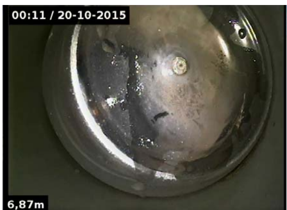
KUVA 15. Tuuletusviemärissä muovipullo, joka on tukkinut sen.
