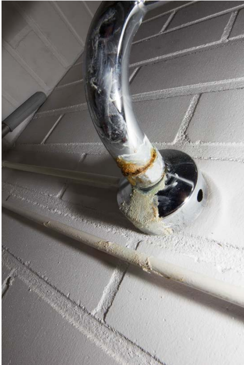
KUVA 27. Siivoukkomeron rätipatterissa vuotojälkiä.
