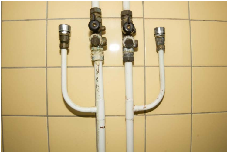
KUVA 21. Yksisuuntaventtiileissä epäilyä sinkinkatoa keittiön astioiden huuhtelupöydässä..
