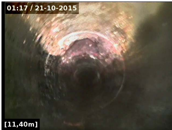
KUVA 16. Puutyöluokan maalaamosta tulevan lavuaarin liittymä kokoojaviemäriin. Maalijätejälkiä on putken yläosaan asti.
