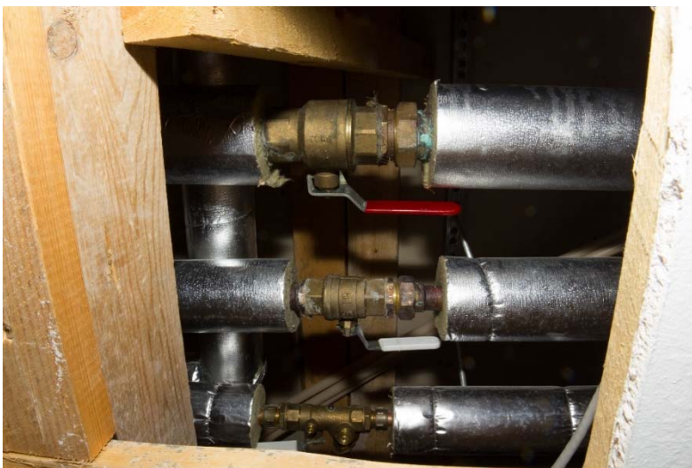
KUVA 19. Kiertoveden linjasäätöventtiileistä puuttui tarvittavat merkinnät
