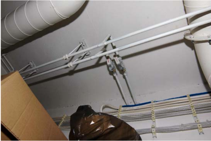
KUVA 36. Yläkoulun lämmitysverkon putkistoa
