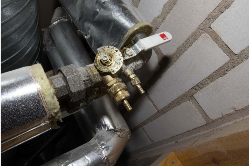
KUVA 32. Venttiili täysin auki asennossa.
