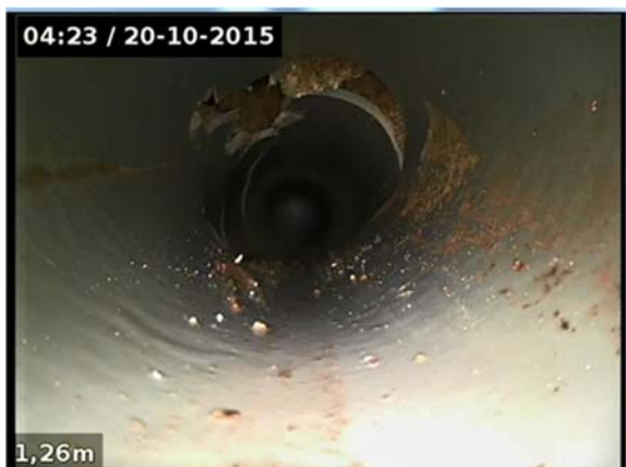
KUVA 12. Haljennut viemäriputki miesten pukuhuoneen suihkutilassa.
