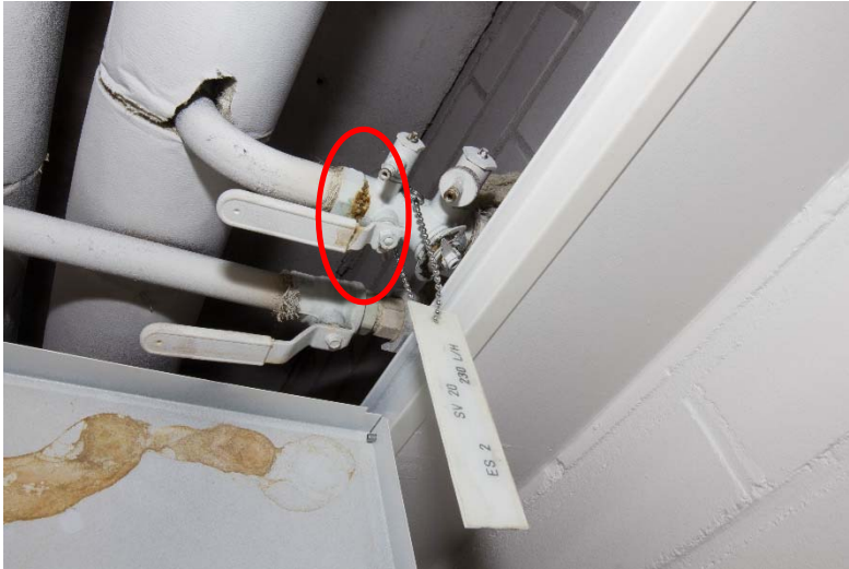
KUVA 41. Linjasäätöventtiilin runko vuotaa vettä.
