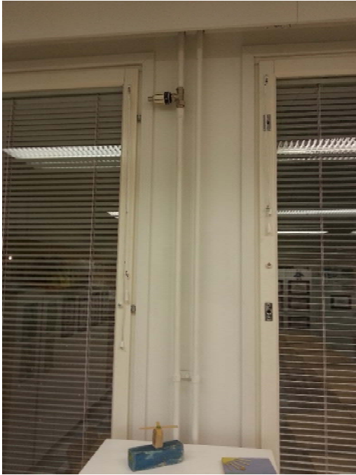
KUVA 29. Luokkatilan lämmitysverkoston linja- ja termostaattiventtiili
