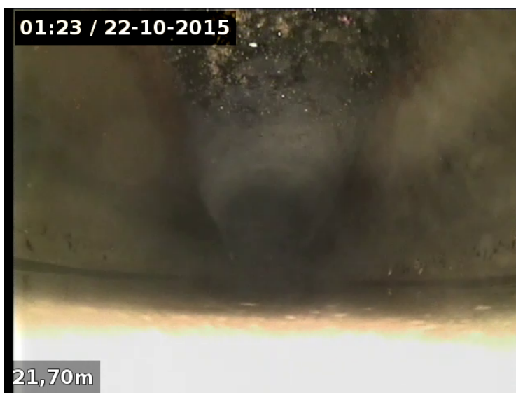
KUVA 11. Ennen rasvakaivoa painuma putkessa
