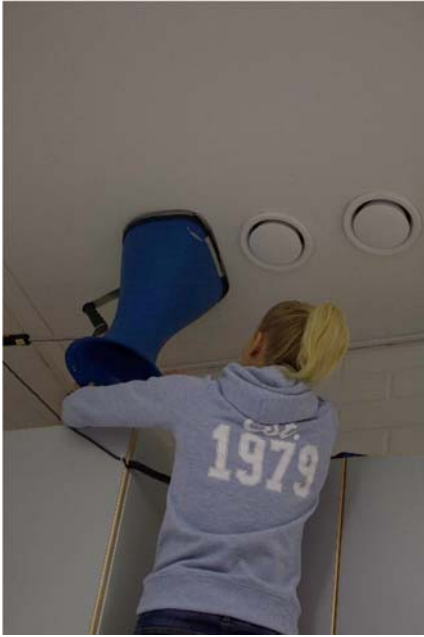
KUVA 5. Poistoilmaventtiin ilmvirran mittaustapahtuma sekä mittauksessa käytetty poistoilmatorvi
