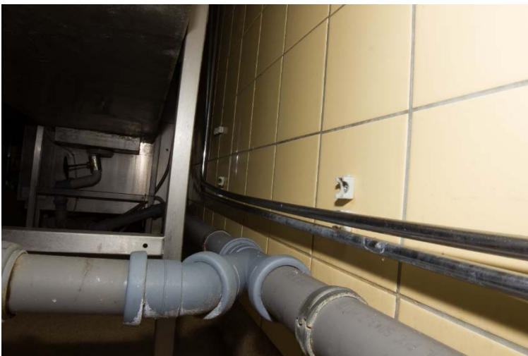
KUVA 22. Keittiön putkien kannakointi puutteellinen
