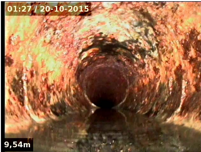
KUVA 18. Väestönsuojan SVK:n viemäriputken pohjalla makaa vesi, putkessa painauma
