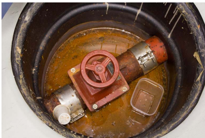
KUVA 17. Väestönsuojan SVK:n pohjalle kertynyt vettä
