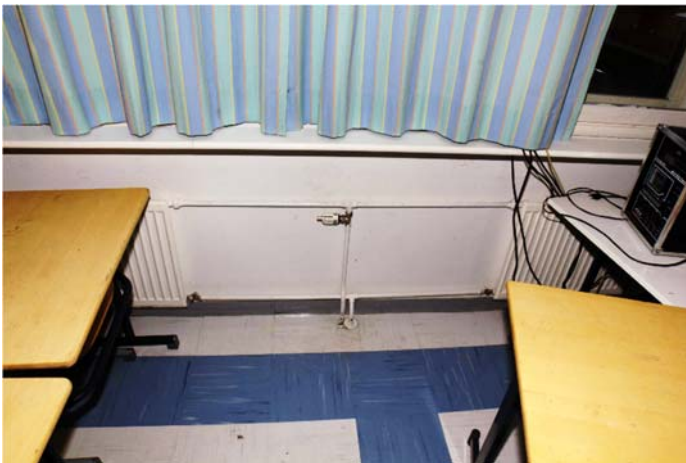
KUVA 35. Yläkoulun pattereiden kunto on kauttaaltaan hyvä.
