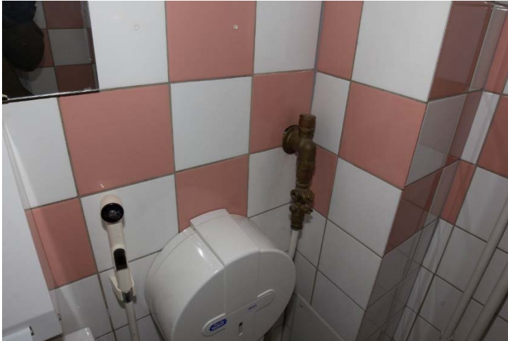
KUVA 23. Wc-tilasta ulkotilaan menevä putki irti.
