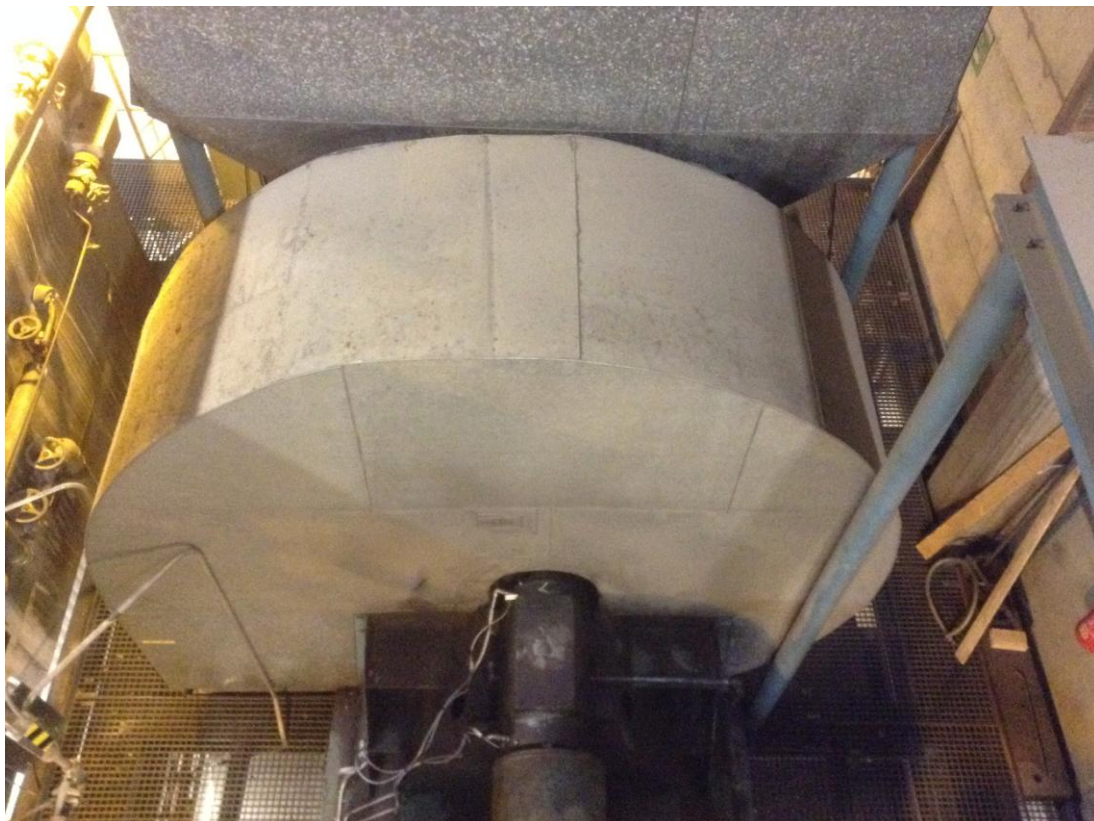
Kuva 7, Palamisilmapuhallin ja kytkin
