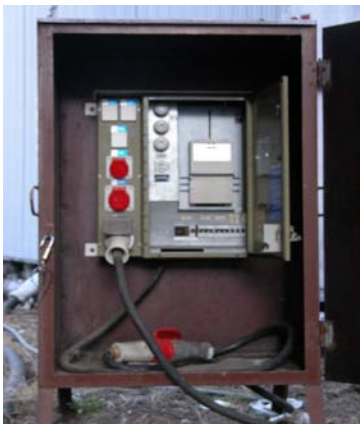
Kuva 16. Kadulta tilattu 3 * 63 A sähkökeskus
