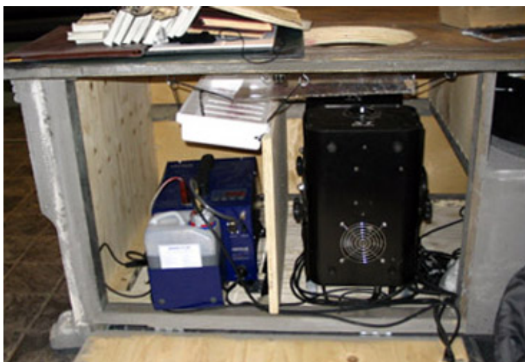
Kuva 4.19 Liemikulhon tekniikkaa pöydän alla
