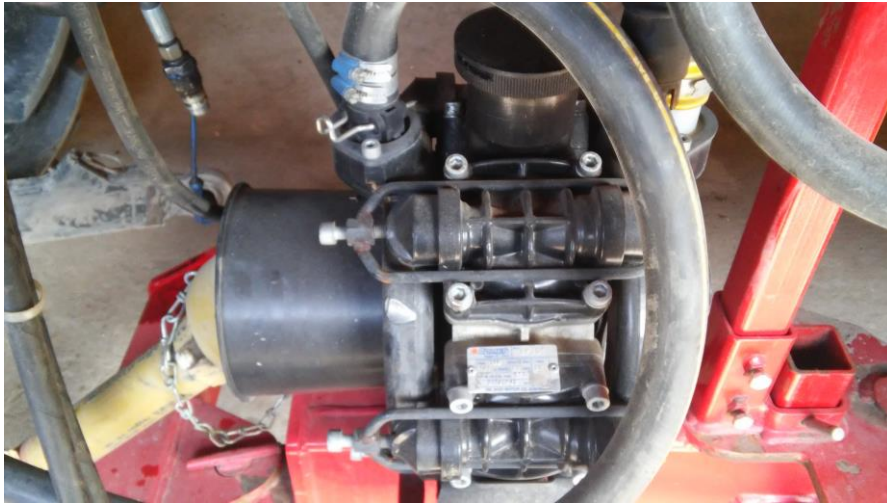
KUVA 21. Kalvopumppu, joka on suoraan kiinni voimanottoakselissa (Kuva: Henri Immonen 2015)
