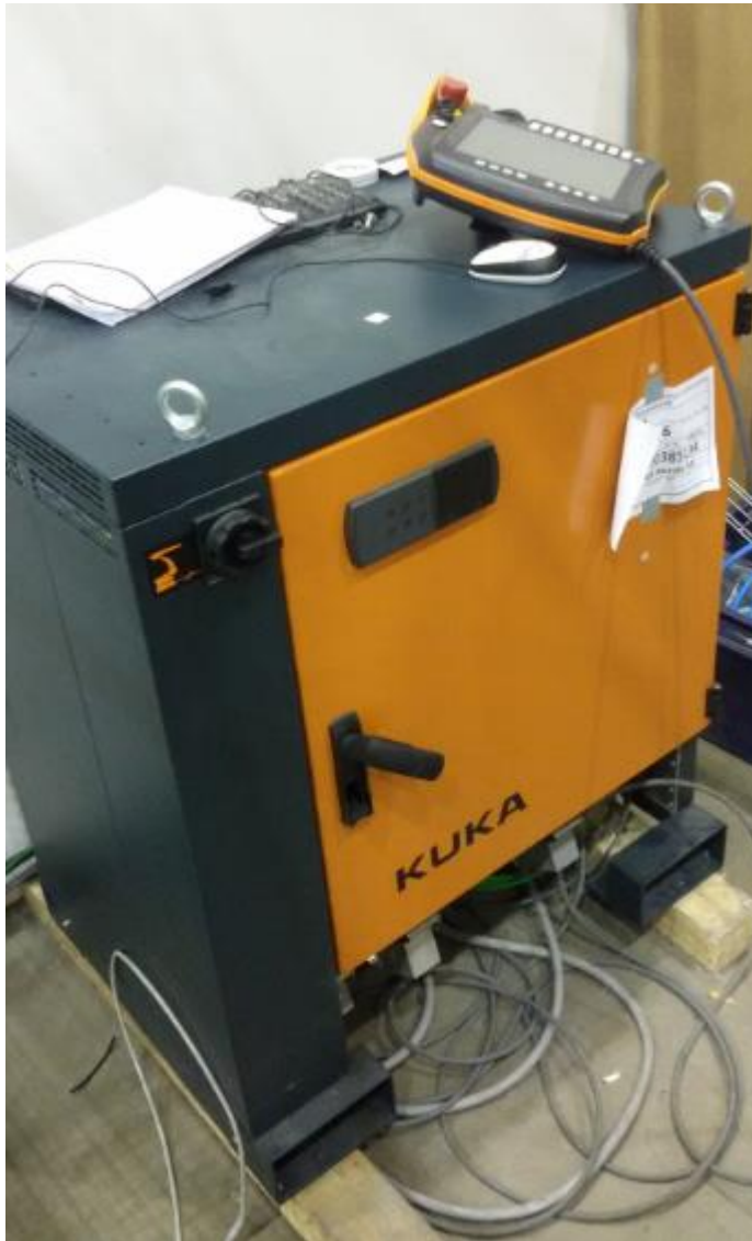
Kuva 18. Robotin ohjausyksikkö. (Soutolahti 2015.)
