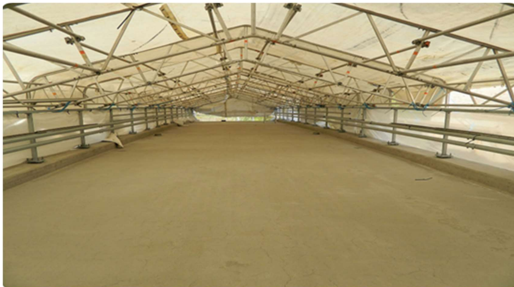
KUVA 1. Vuokrattu sääsuoja sisältäpäin. (Liikennevirasto 2014, 1)
