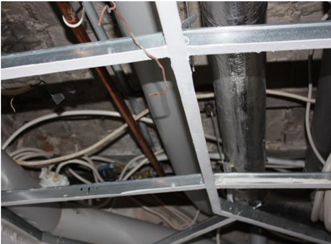
Kuva 5. Talotekniikkaa käytävän katossa.
