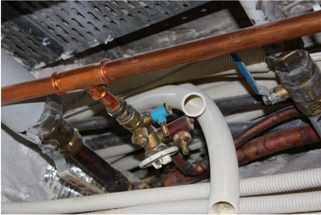
Kuva 4. Eristämättömiä putkia käytävän alas lasketussa katossa.
