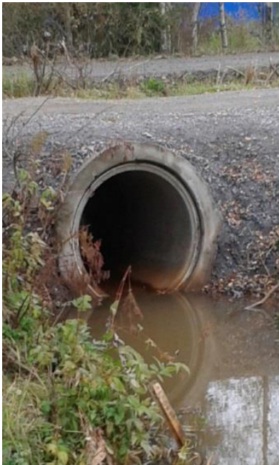
KUVIO 4. Väärin asennettu ojarumpu.
