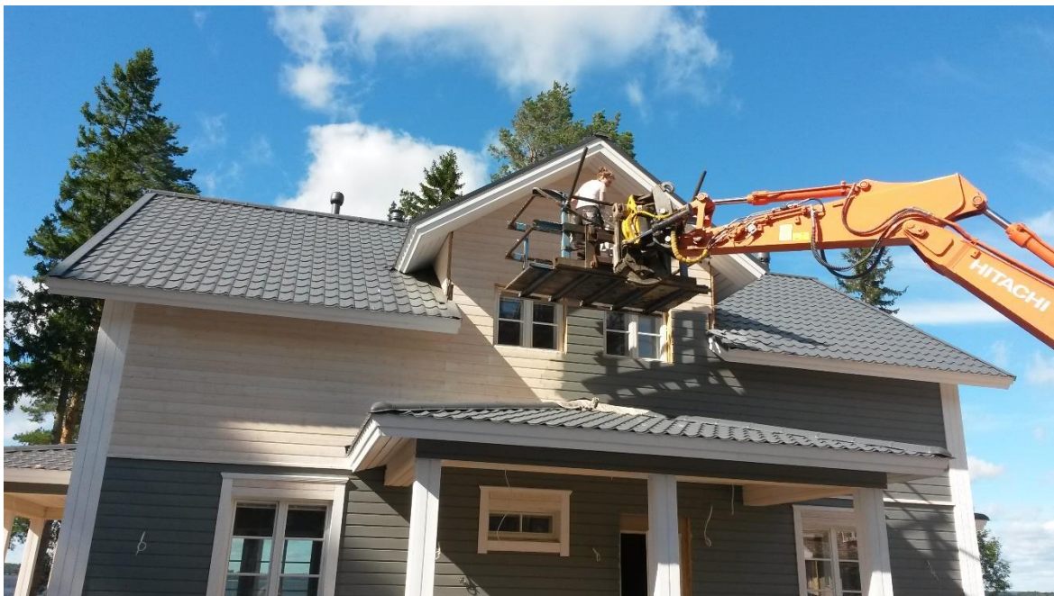
Kuva 12. Maalaustyötä ilman suojakypärää, hyväksymättömästä nostokorista.
