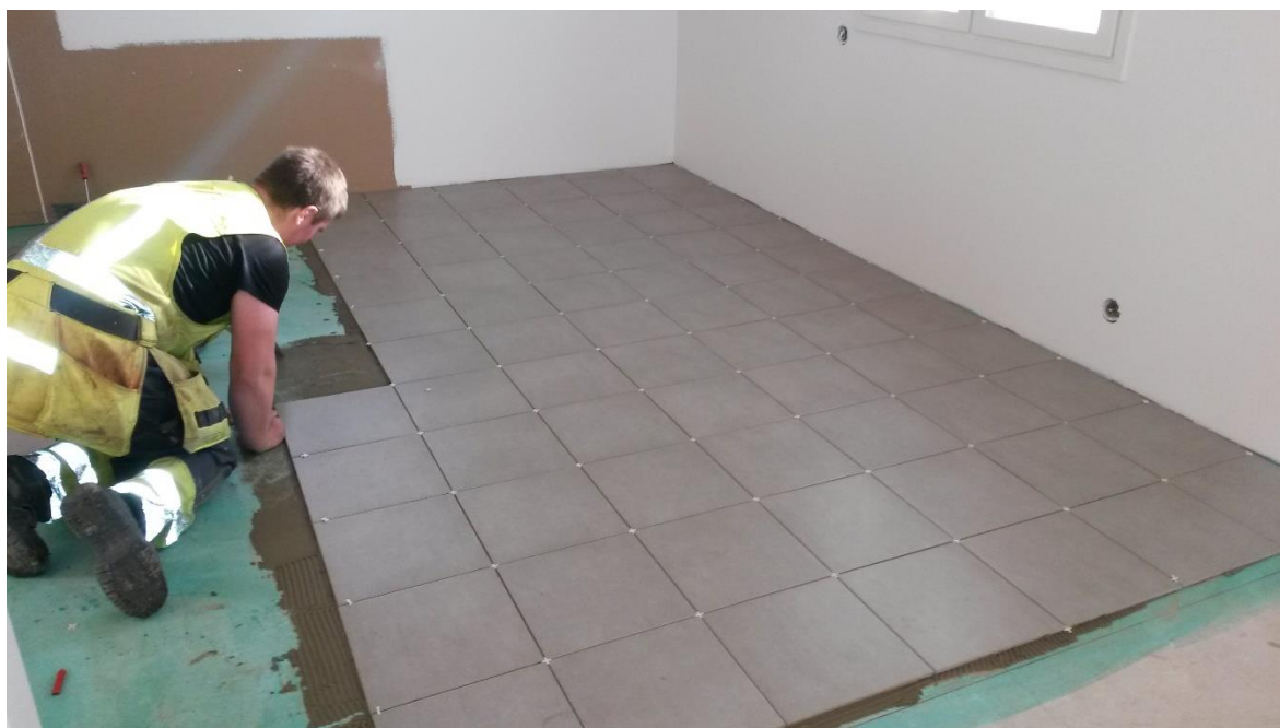
Kuva 9. Lattialaatoituksen asennusta ilman suojakypärää.
