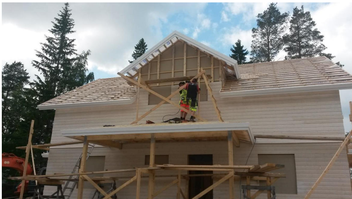
Kuva 8. Työskentelyä ilman suojakypäriä hyväksymättömillä telineillä ja puutteellisella putoamissuojauksella.
