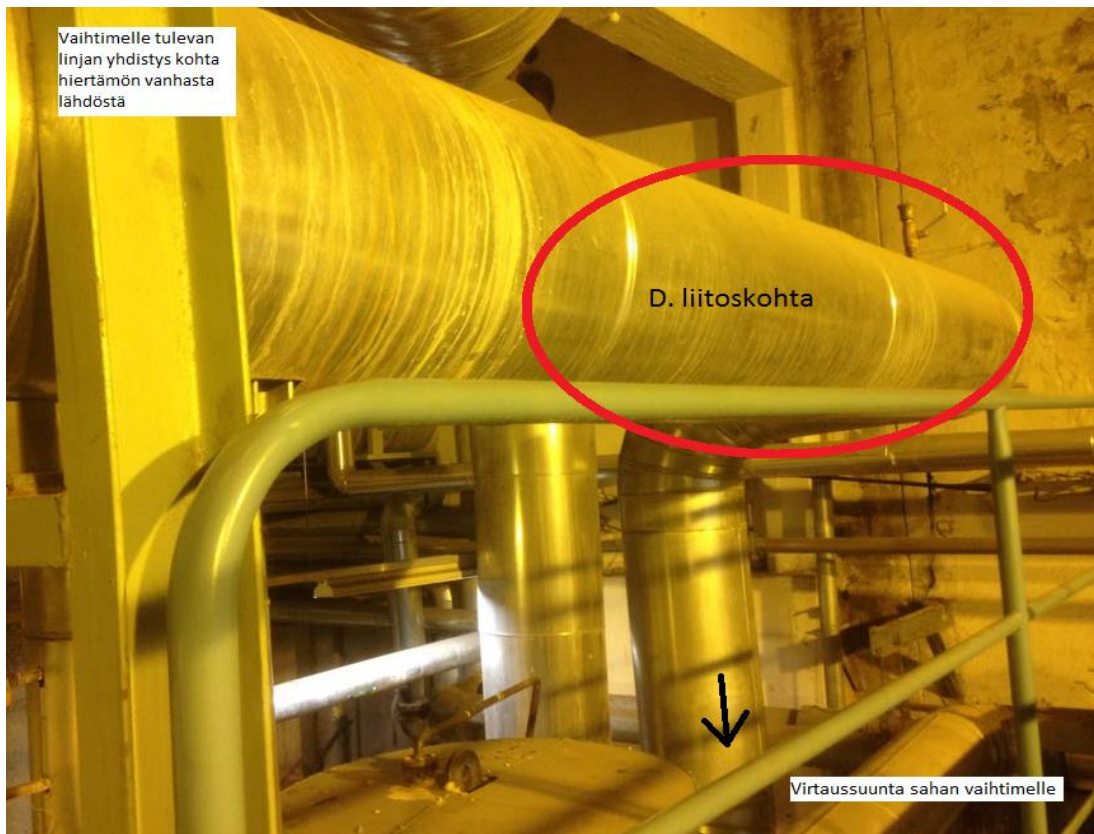
Kuva 16. Kohta D. lämmönsiirtimelle tulevan putkiliitoksen paikka.
