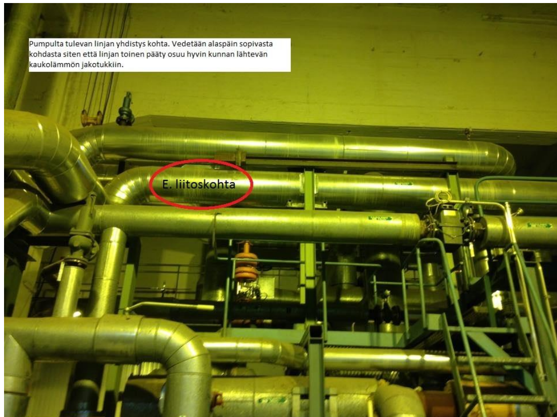
Kuva 17. Kohta E. pumpulta tulevan putken liitoskohta.
