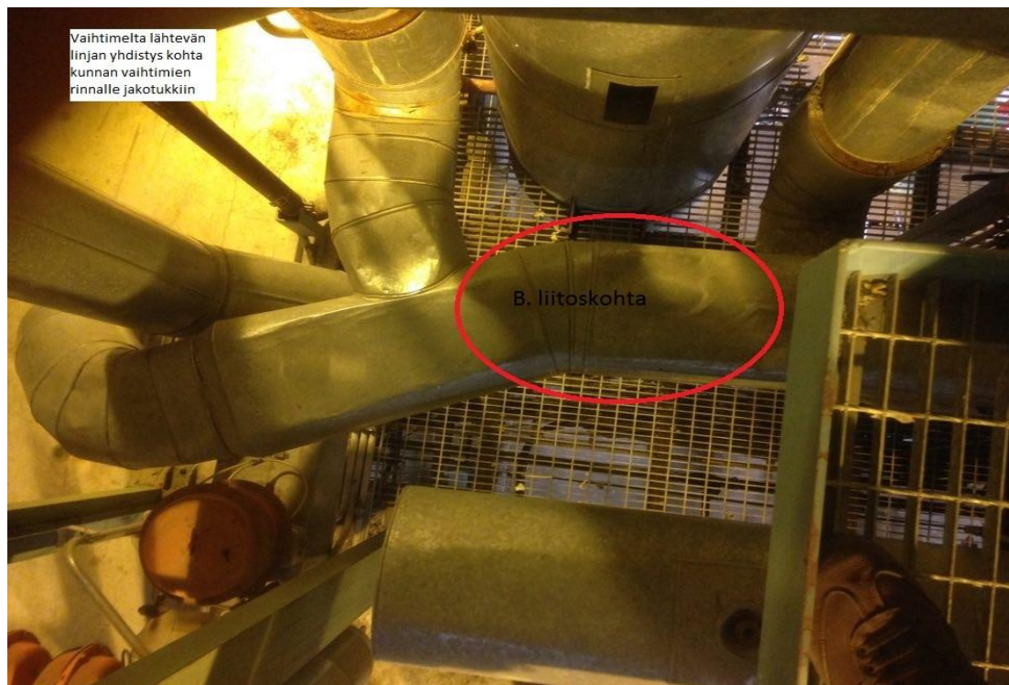
Kuva 14. Kohta B. lämmönsiirtimeltä tulevan putken toinen liitoskohta.
