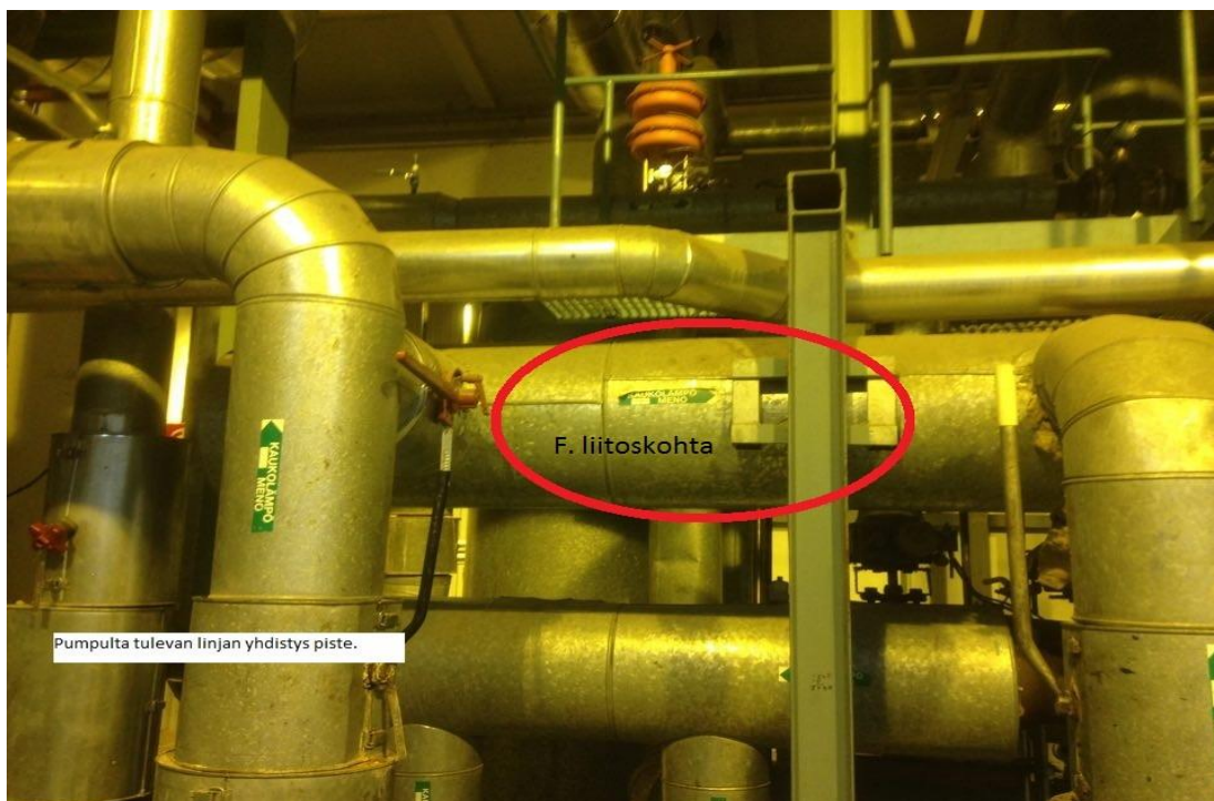
Kuva 19. Kohta F. sahan pumpulta tulevan linjan liitoskohta kunnan pumppujen rinnalle.
