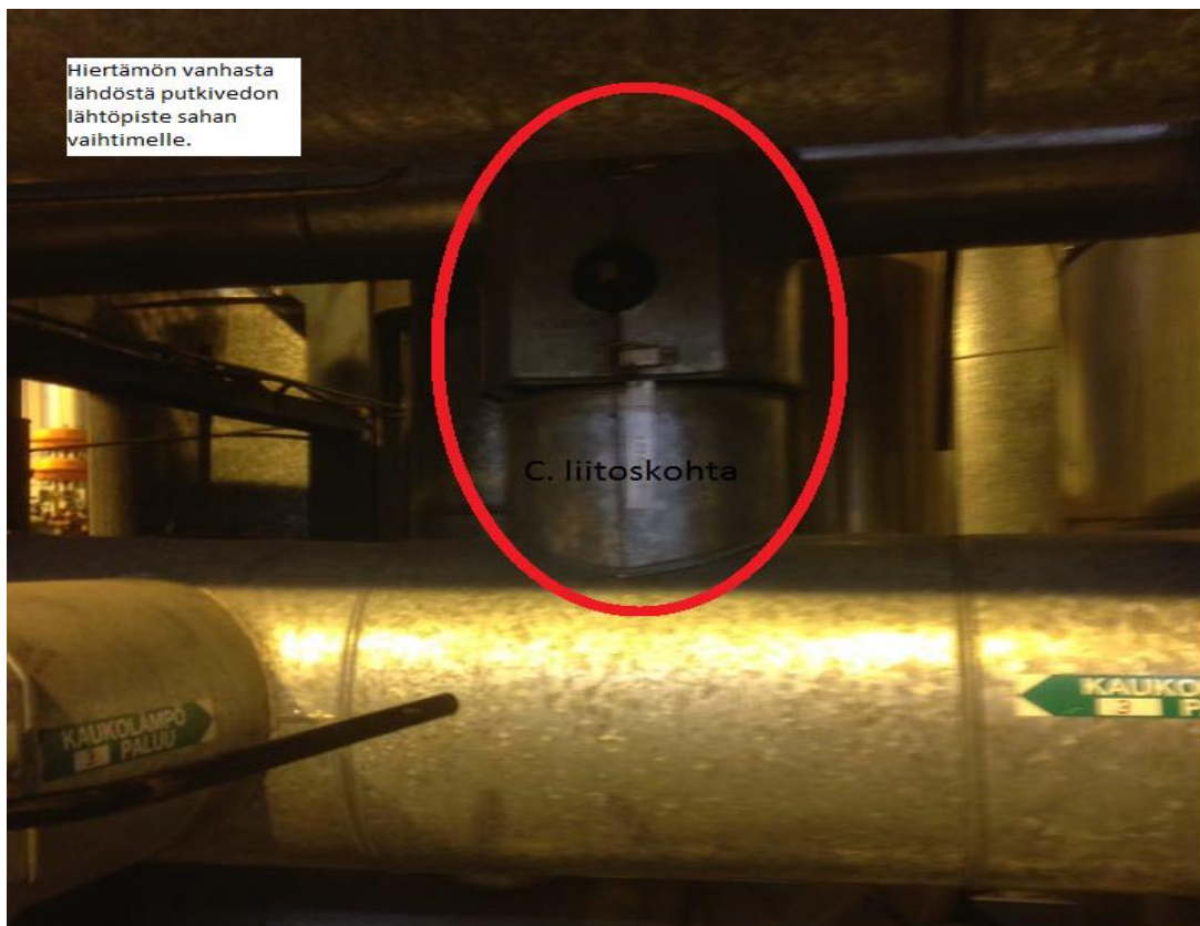
Kuva 15. Kohta C. lämmönsiirtimelle lähtevän putken liitoskohta vanhasta tulpatusta lähdestä.
